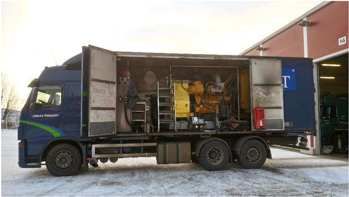
Kuva 5. Kiinteästi kuorma-auton konttiin asennettu 1000 baarin korkeapainelaitteisto.
