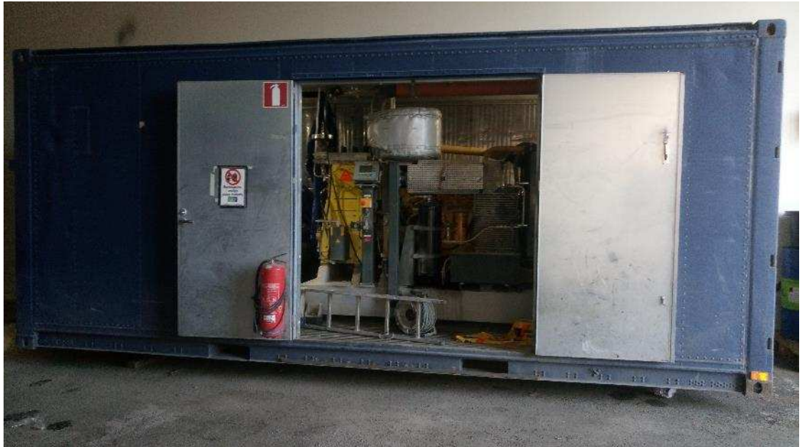
Kuva 6. Vaihtolavakonttiin rakennettu ultrakorkeapainelaitteisto.
