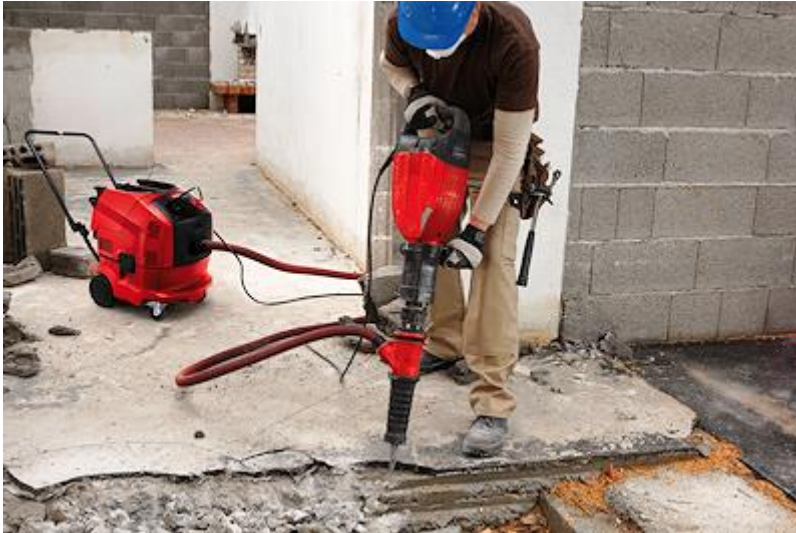
KUVA 6. Korkeapaineinen kohdepoistojärjestelmä. (Koski ym. 2013, 9)
