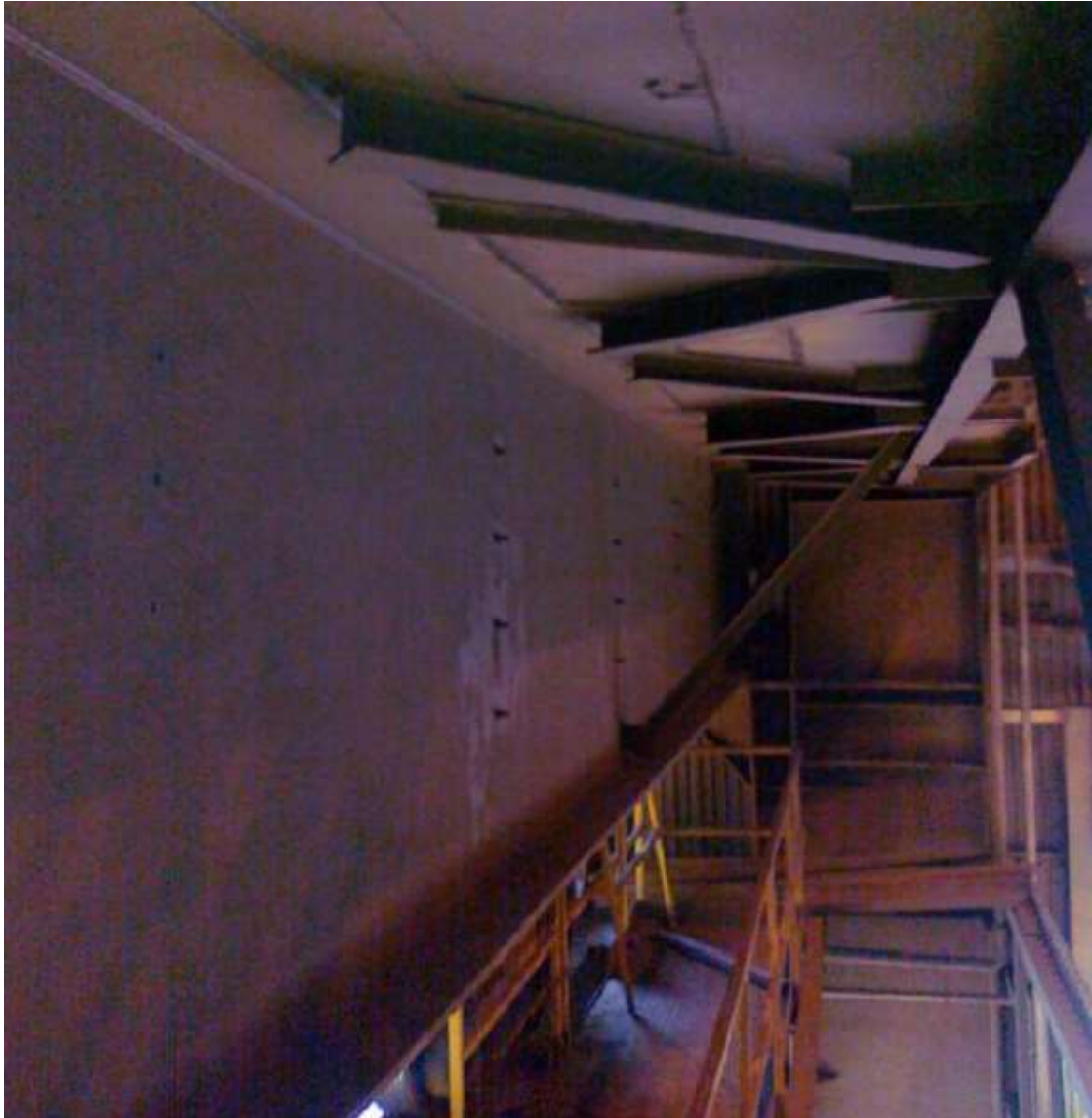
KUVA 6. Ratapalkin tuenta kiepahdukselle. Ratapalkin ylälaippa sivutuettu koko jännevälin pituudeltaan hoitotason ja vaakaturistikon jäykistysyhdistelmään. Alalaipan diagonaalit ovat jännevälin kolmannespisteissä. (SSAB dokumentti nro 4730639, 4.)
