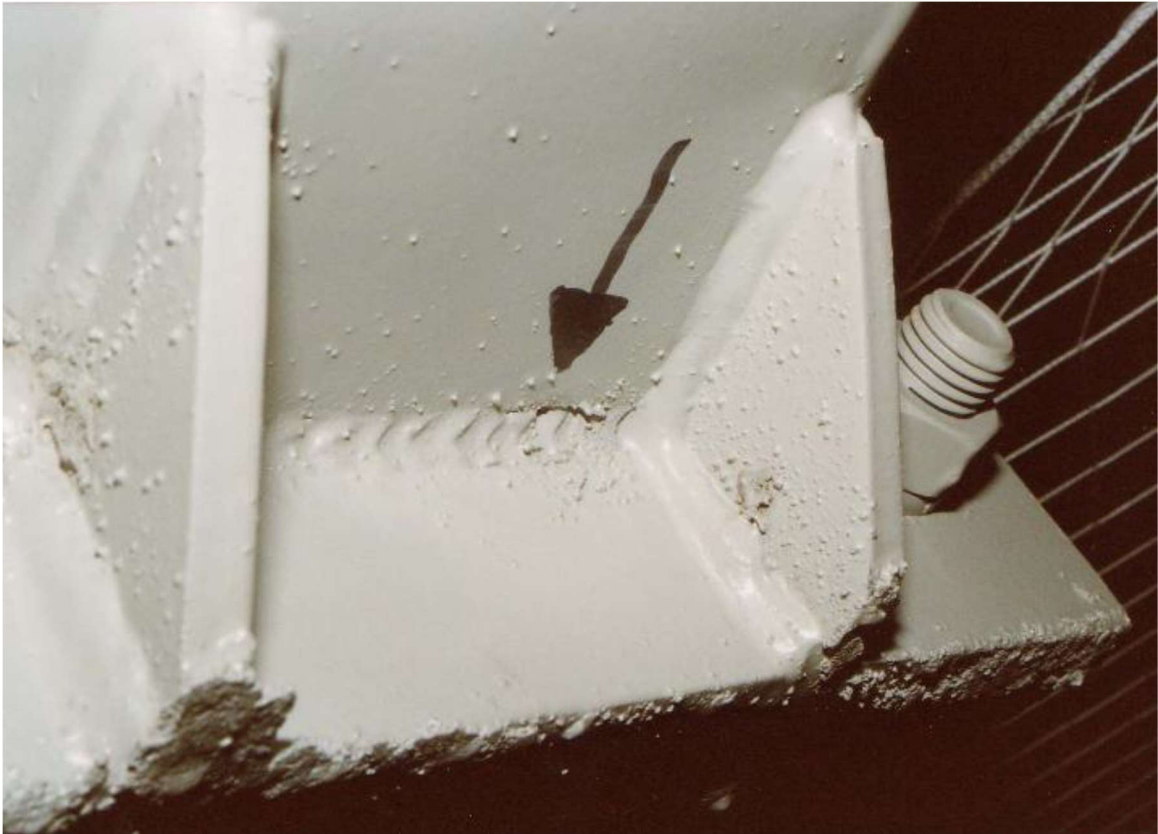
KUVA 15. Silmin havaittava halkeama hitsausliitoksessa (Teräsrunkorakenteiden kuntotarkastusohje. 2006, 17).
