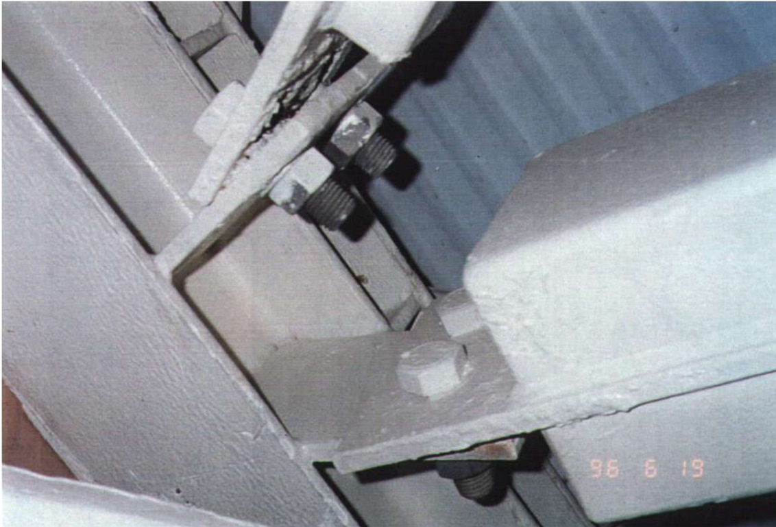
KUVA 16. Kiinnitettävissä teräsrakenneosissa rako. Ruuviliitos löysällä ja täytyy kiristää. Liitoksen kaltaista epäkeskeisyyttä myös pyrittävä välittämään. (Teräsrunkorakenteiden kuntotarkastusohje. 2006, 15.)
