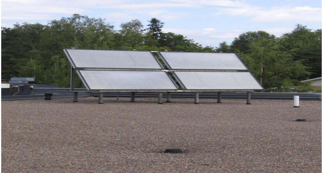
KUVA 1: A-rakennuksen katolla sijaitseva aurinkokeräin
