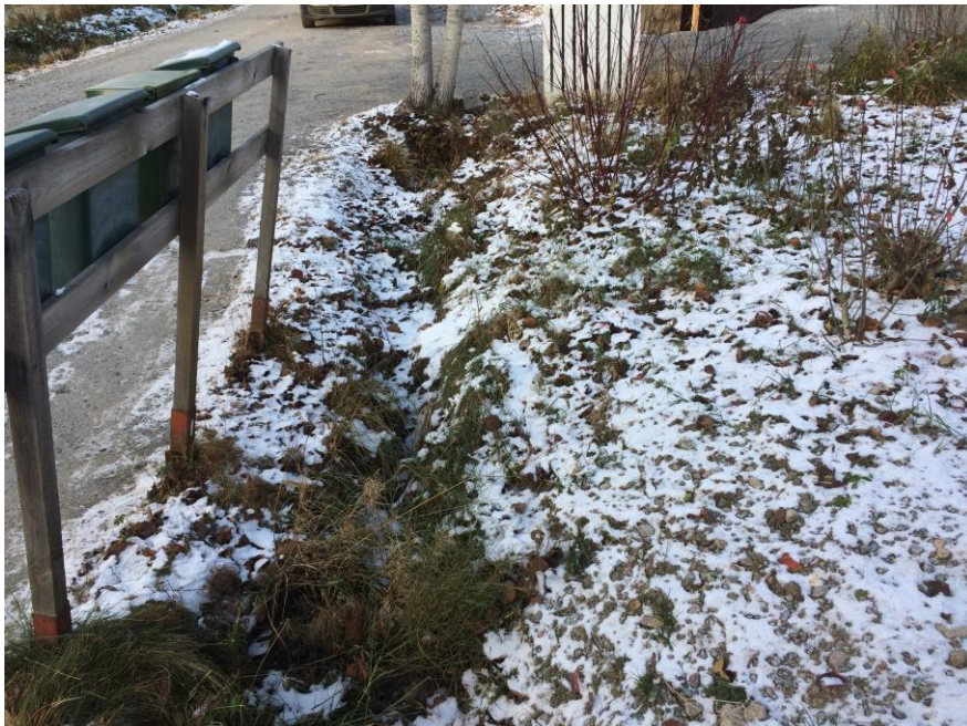
Kuva 39. Avo-oja ja sen päässä oleva hautautunut tai kokonaan puuttuva rumpu
