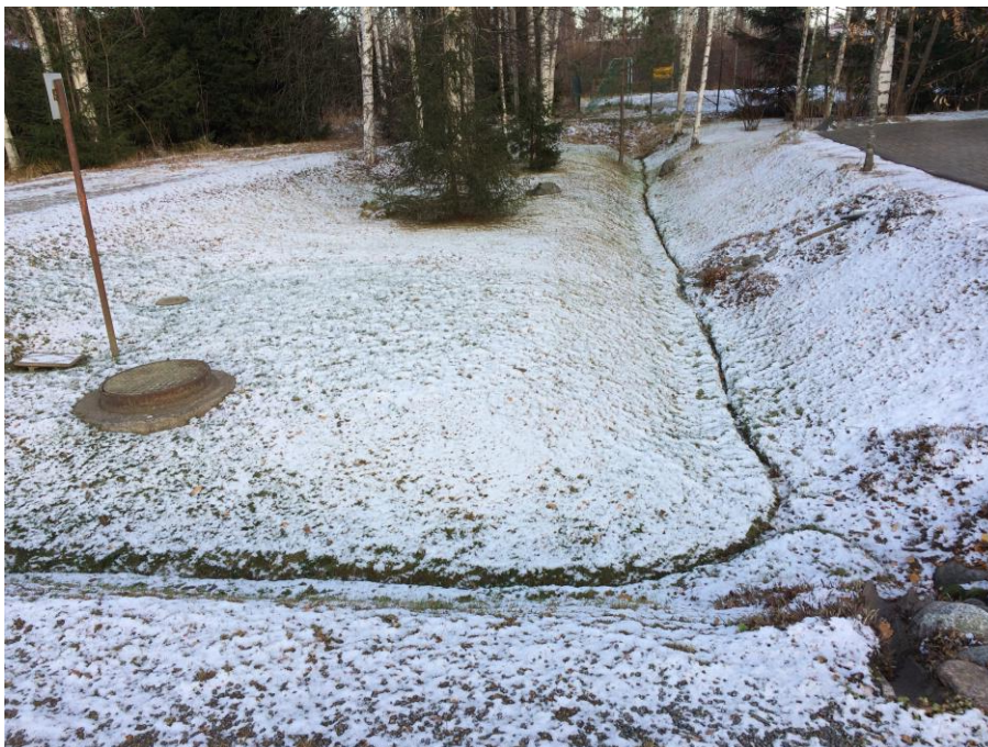
Kuva 53. Lumitien hulevedet eteenpäin johtava avo-oja
