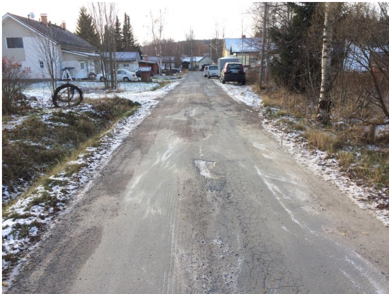
Kuva 40. Usvatie ja sen puutteellinen kuivatus
