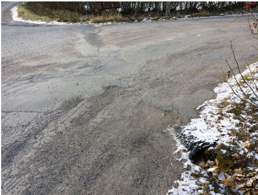
Kuva 57. Liittymäalueella sijaitseva erittäin huonokuntoinen tierumpu
