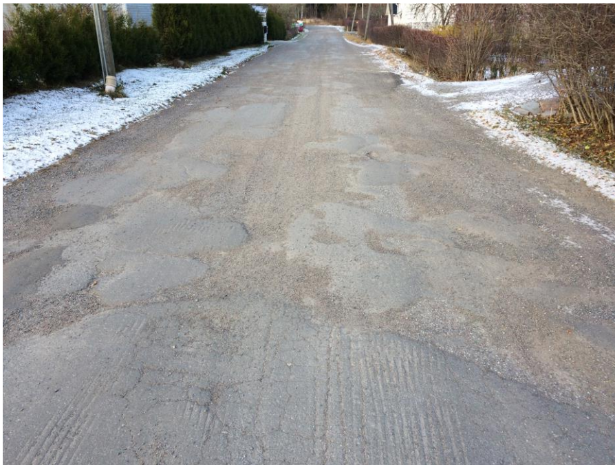
Kuva 61. Talouskaupantien päällysteen vauriot
