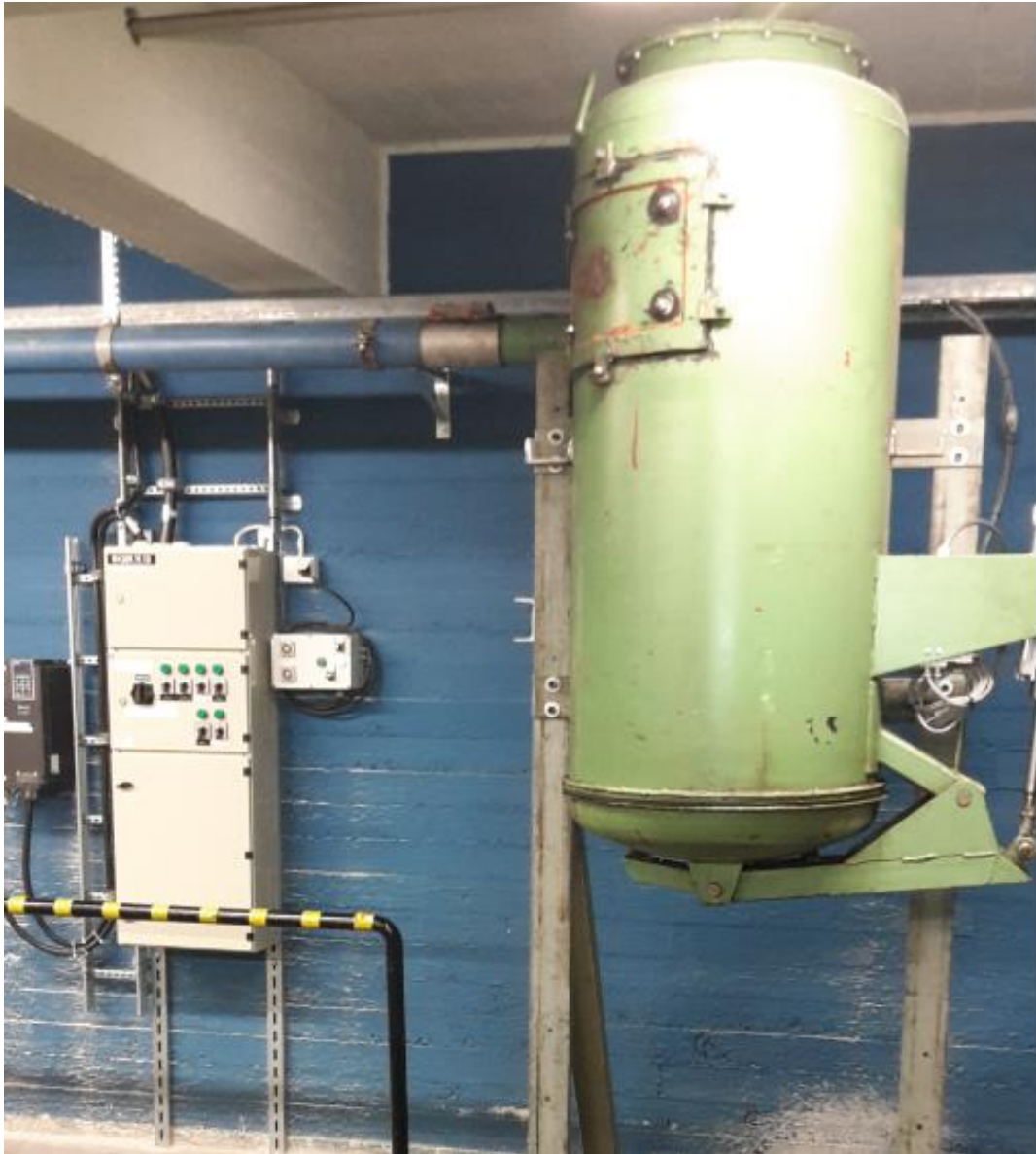
Kuva 20. Sähkökaappi imupytytyn vieressä valmiiksi asennettuna.
