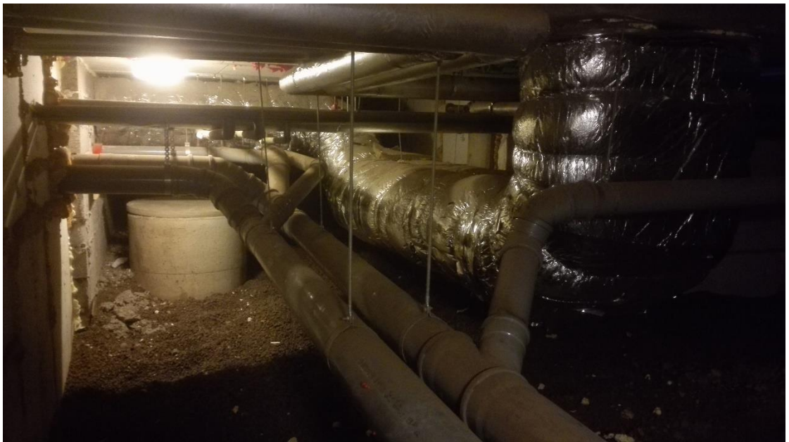
Kuva 7. Ryömintätilassa on valaistus ja katkaisin sijaitsevat heti huoltoluukun vieressä.
