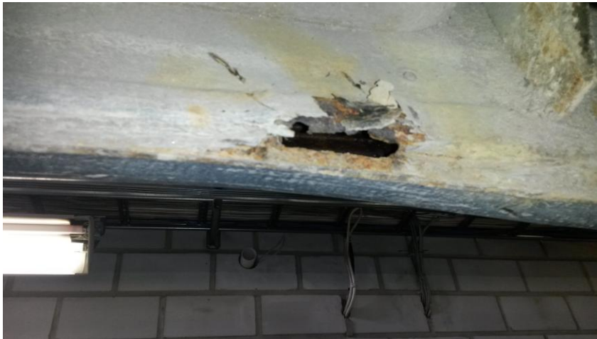
KUVA 3. Korjauskehotuksen arvoinen ruostevaurio sisähelmakotelossa. Lähde: Pekka Purosola 2015.
