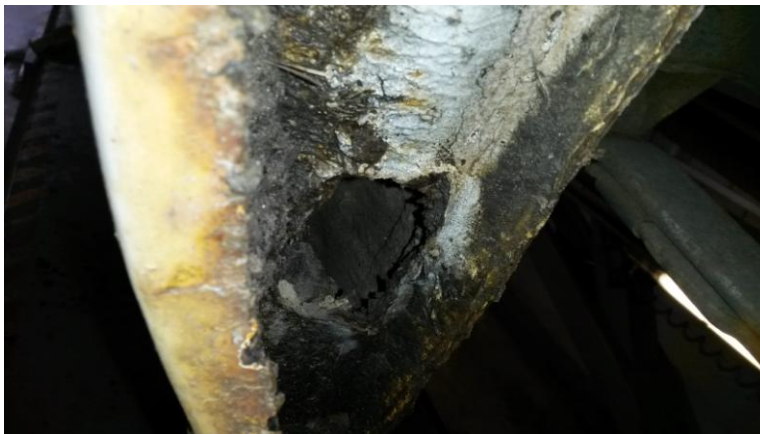
KUVA 5. Pyörän kotelon ruostevaurio. Tämä on rajatapaus, jonka arvosteleminen on katsastajan harkinnassa. Laajemmasta auto menee ilman muuta hylkyyn. Lähde: Pekka Purosola 2015.
