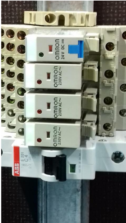
Kuva 8. Releet, niiden apukoskettimet sekä johdonsuojakatkaisija kiinnitettynä kiskoon.
