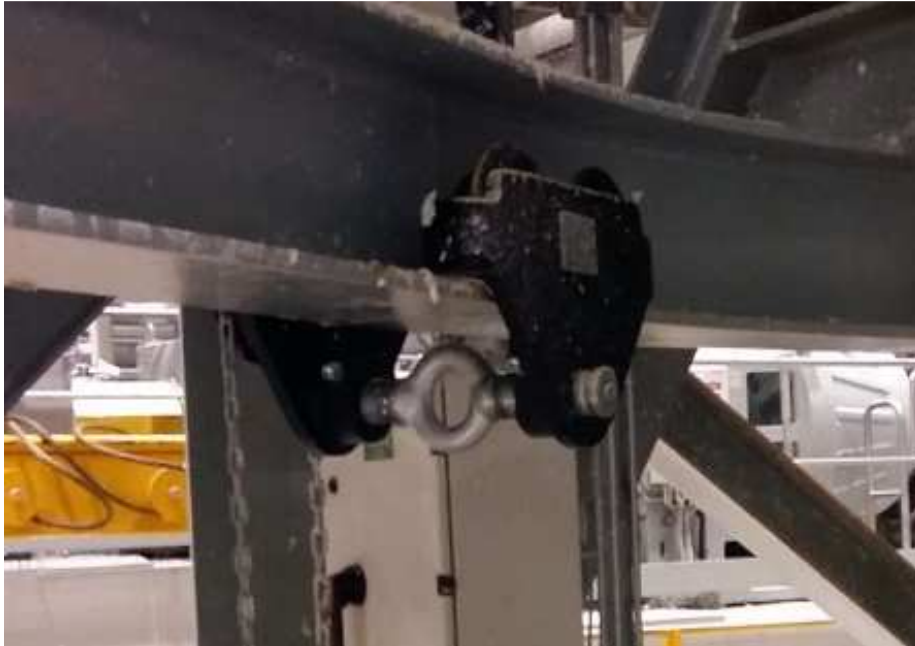
Kuva 4, Esimerkki siirtovaunusta Kaukopään tehtaalta.
