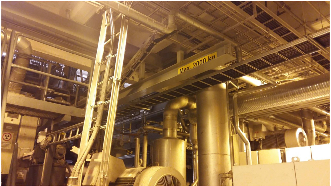
Kuva 3, 2000 kg:n nostokisko Kaukopään tehtaalta.
