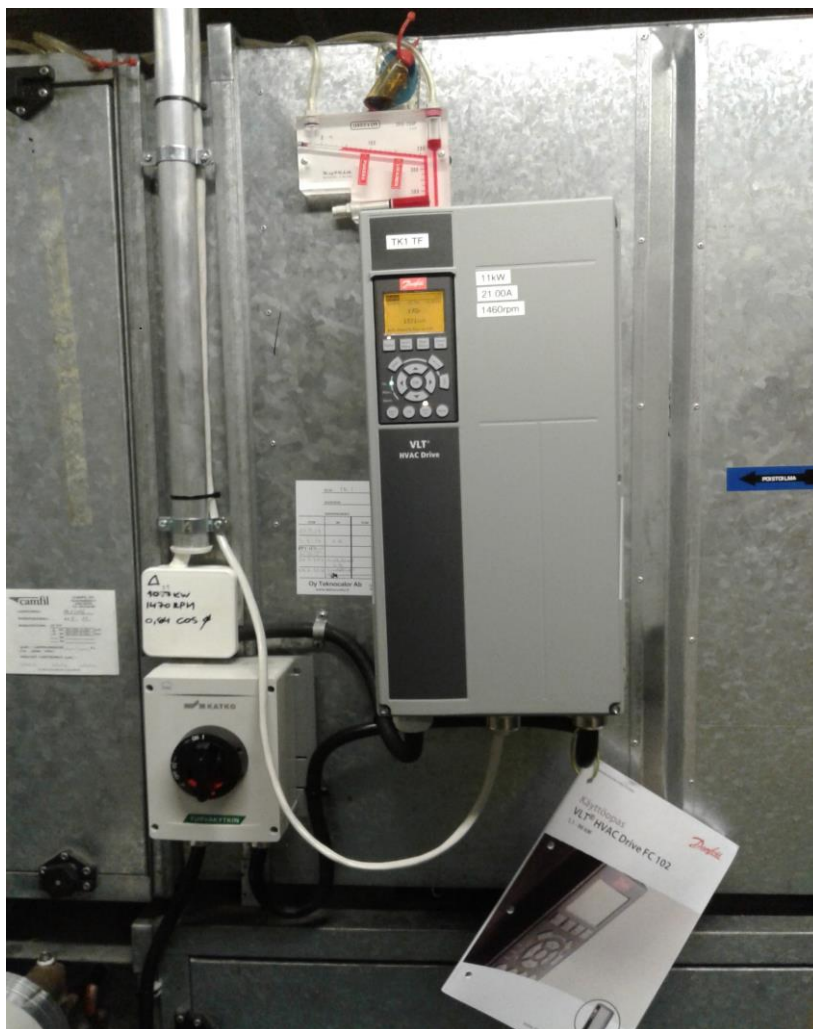
Kuva 22 TK1 tulopuhaltimen taajuusmuuttaja ja turvakytkin.
