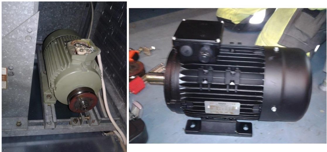
Kuva 19 TK2:n vanha moottori vielä paikallaan vasemmalla ja oikealla uusi moottori odottamassa asennusta.
