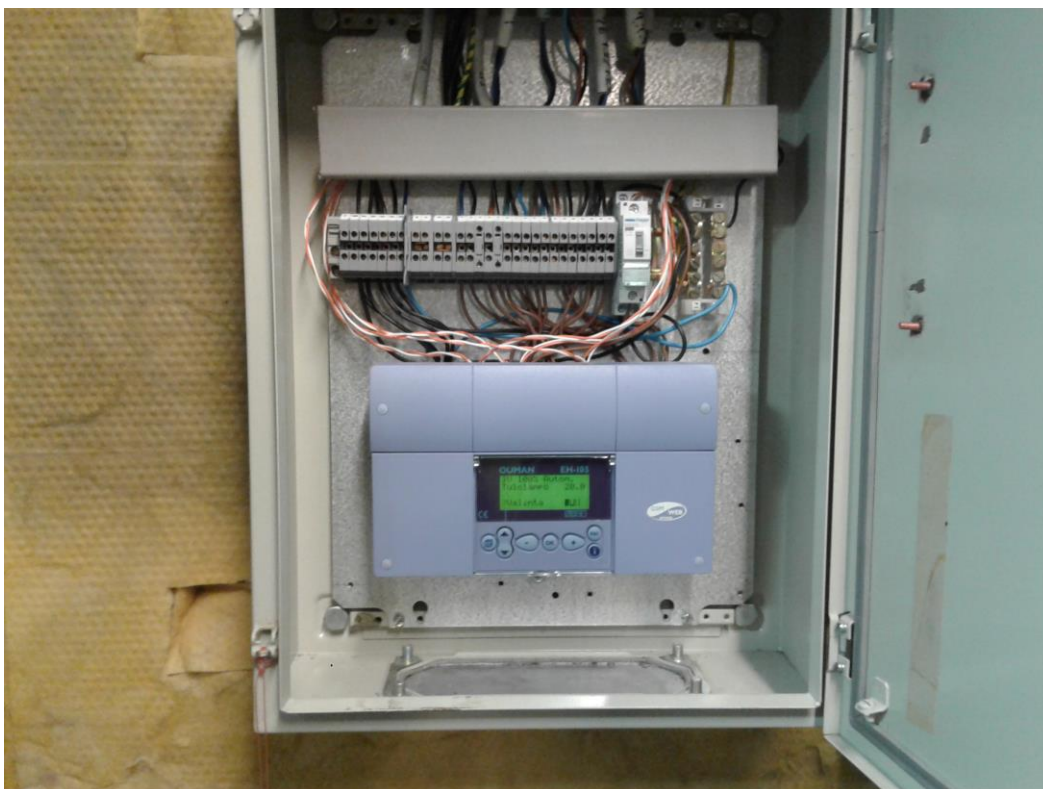
Kuva 25 Uusi Ouman EH-105-säädin asennettuna säätölaitekoteloon.
