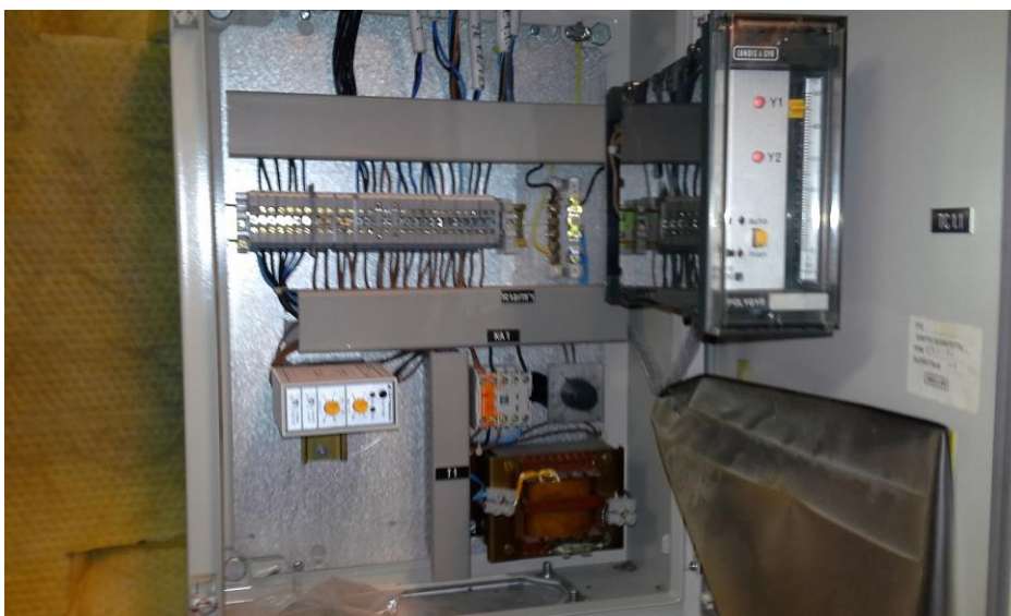
Kuva 23 TK1:n vanhat säätölaitteet.
