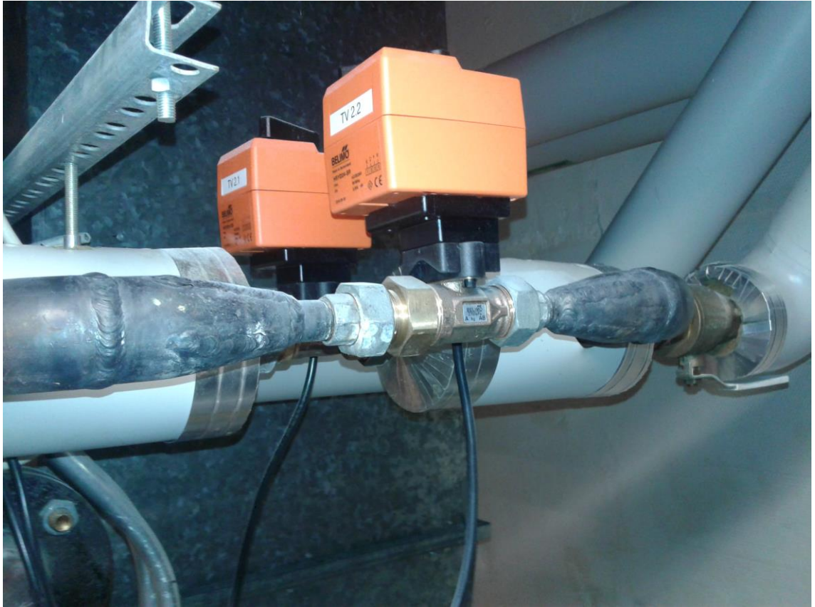
Kuva 16 TK2:n uudet venttiilit ja toimilaitteet. Sovittepala on messinkinen mutterin näköinen osa venttiilin vasemmassa päässä.
