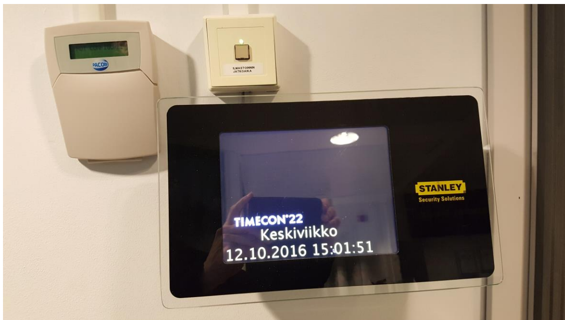
Kuva 44. Murtosuojauksen käyttöpaneeli, Timecon Touch–työaikapäätte ja ilmastoinin jatkoaikapainike.
