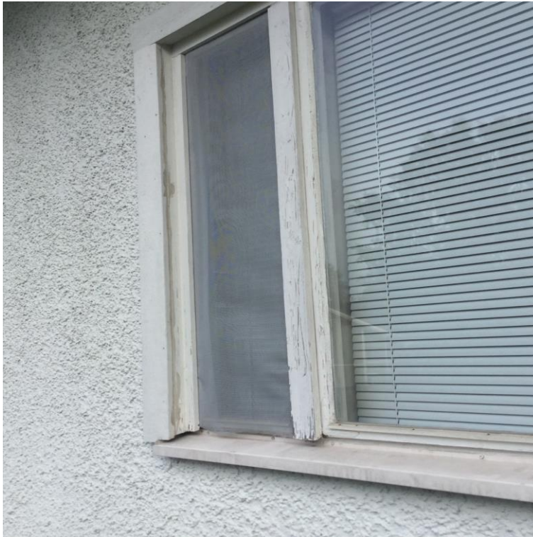
Kuva 16 Ikkunoiden hilseillyt maalipinta
