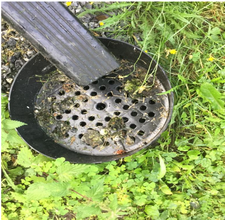
Kuva 1. Rännin ohjaus sadevesikaivoon.
