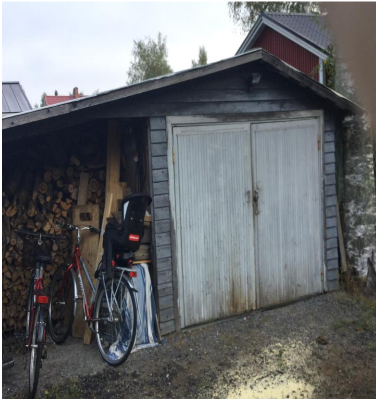
Kuva 3 Varastosta laajalti hilseillyt maalipinta.
