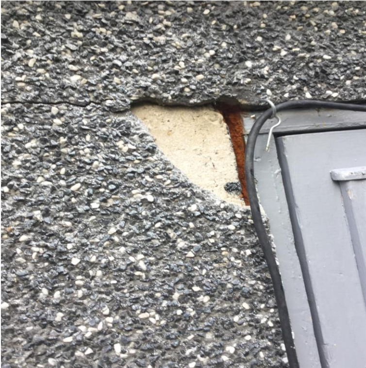
Kuva 14 Irronnut rappaus oven liittymässä.
