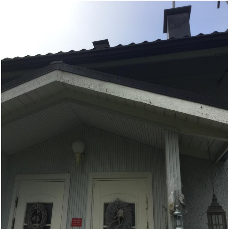
Kuva 19 Otsalaudan hilseillyt maalipinta.
