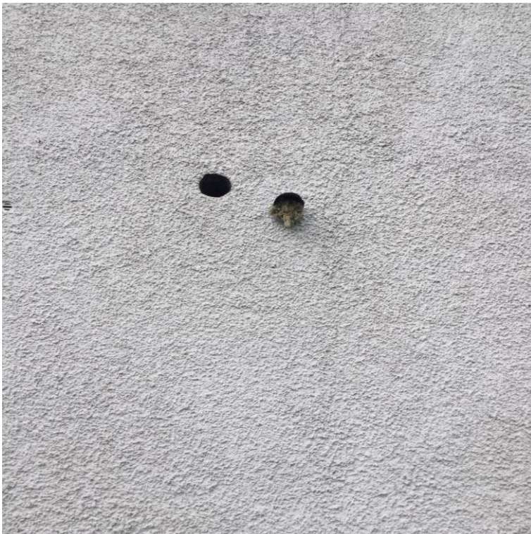
Kuva 15 Puuttuva poistoilma venttiili.
