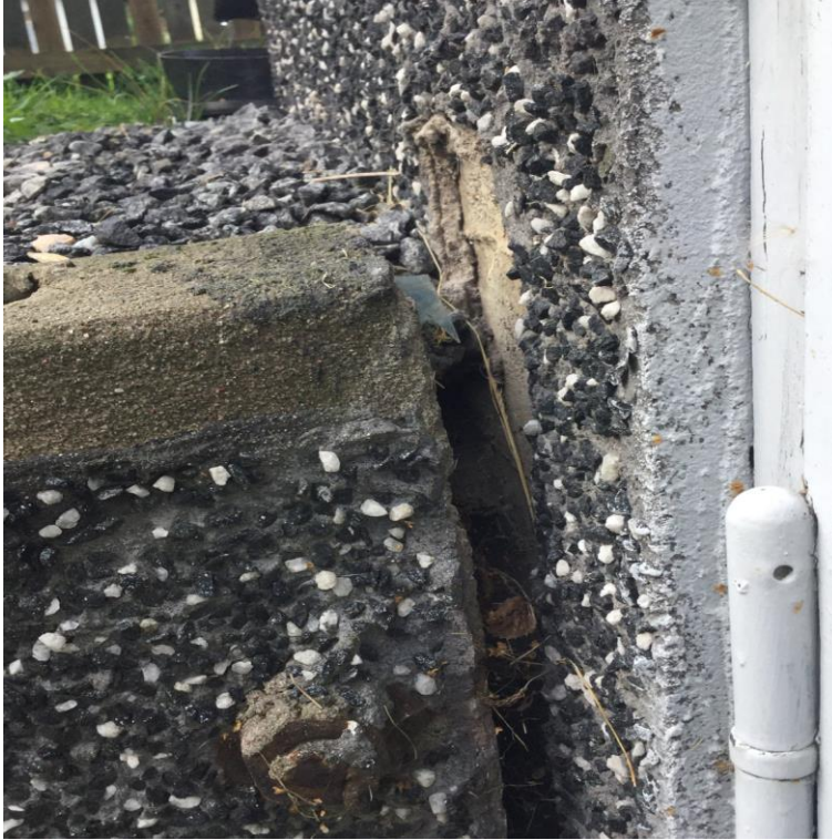
Kuva 8 Tukimuurin irronnut rakennuksesta.
