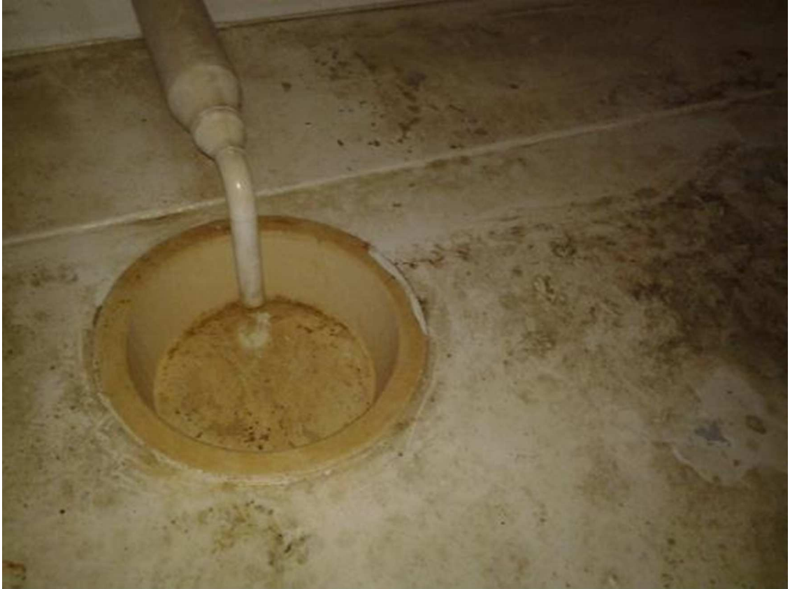
Kuva 5. Pohjakaivo ja imuputki.
