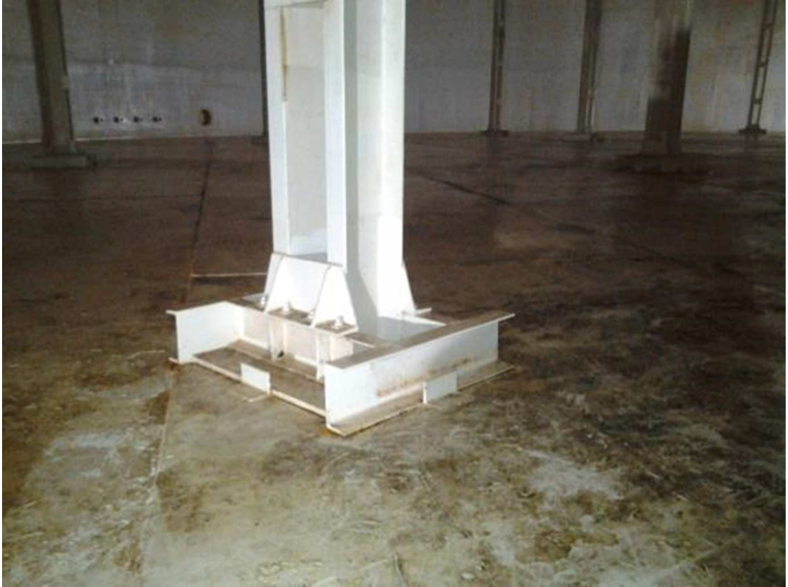
Kuva 8. Säiliön kattoa tukevat massiiviset tukijalat. Taustalla vaipassa näkyvät myös suljetut putkiyhteet ja miesluukku.
