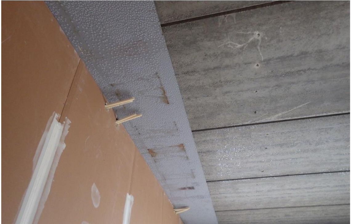
Kuva 12. Ilmanvaihto ja lämmitys eivät olleet riittäviä, minkä johdosta delta-palkkiin tiivistyvä kondenssivesi turmeli kevyen väliseinän vaihtokuntoon.
