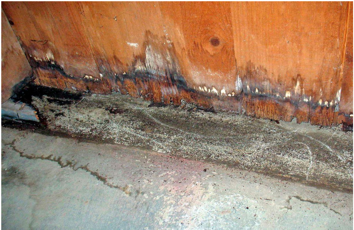
Kuva 7. Mikrobikasvustoa seinän ja alapohjan liittymässä. [17.]
