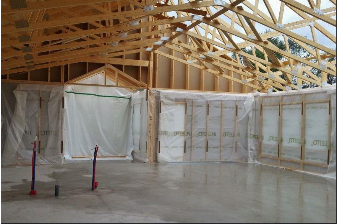
Kuva 3. Keskeneräisen katon ja puuttuvan sääsuojauksen vuoksi kastunut betonilaatta. [15.]
