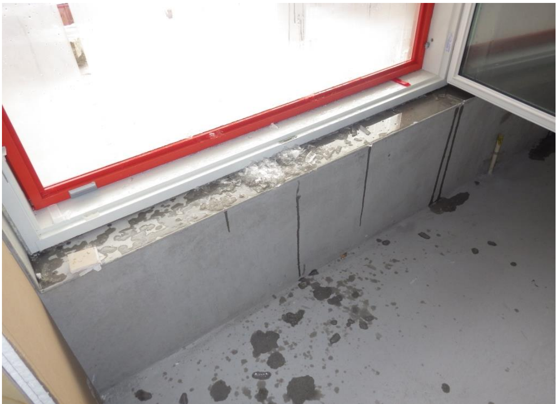
Kuva 11. Ylipaineinen rakennus voi kerätä merkittäviä määriä kosteutta kylmiin rakenneseisiin.
