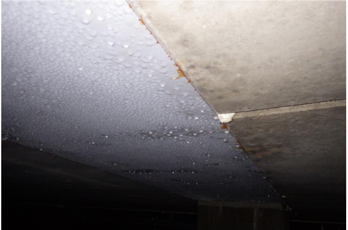
Kuva 10. Ryömintätalillisen alapohjan työnaikainen ilmanvaihto ei ollut riittävä.
