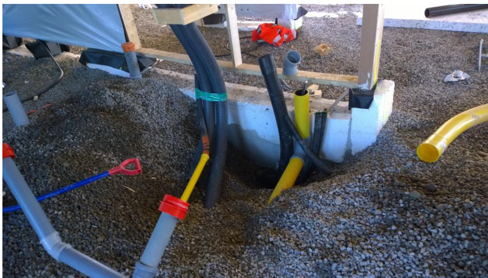
Kuva 5. Kaapelien putkitukset pääkeskuksen kohdalla, jotka on tuettu väliseinän mukaisesti
