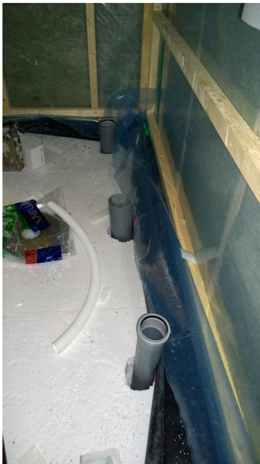
Kuva 9. Sähkön läpivientiputket tuulettuvissa alapohjissa
