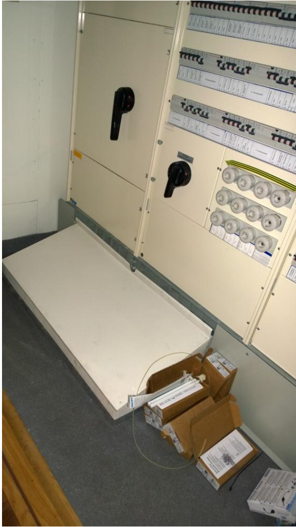
Kuva 7. Keskuksen kaapelointi ei ole osunut kohdalleen
