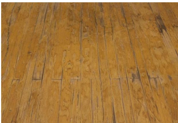
Kuva 8. Kosteuden aiheuttamia vaurioita
