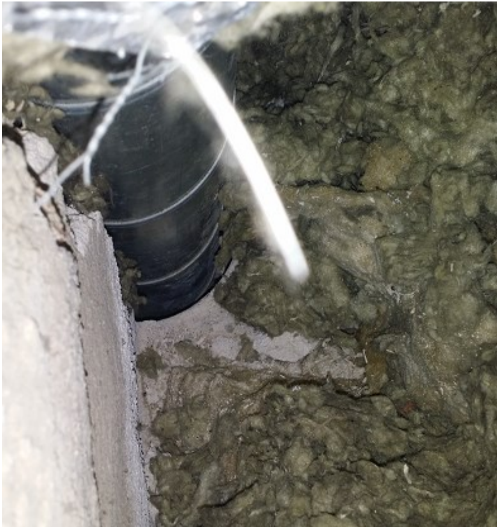
Kuva 2. Tiivistämätön ilmanvaihtoputken läpivienti rakennuksen yläpohjassa sekä lämmöneristeenä käytettyä mineraalipuhallusvillaa.
