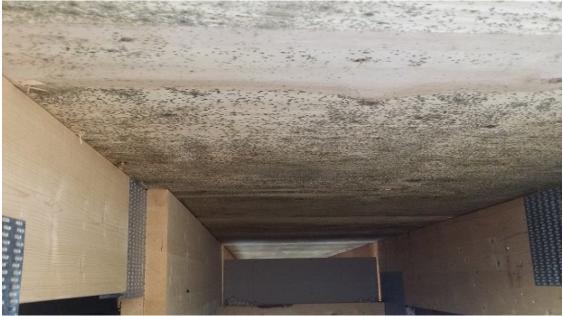
Kuva 4. Tuuletuksen puutteen ja lämpövuotojen aiheuttamaa mikrobikasvustoa rakennuksen yläpohjarakenteessa.
