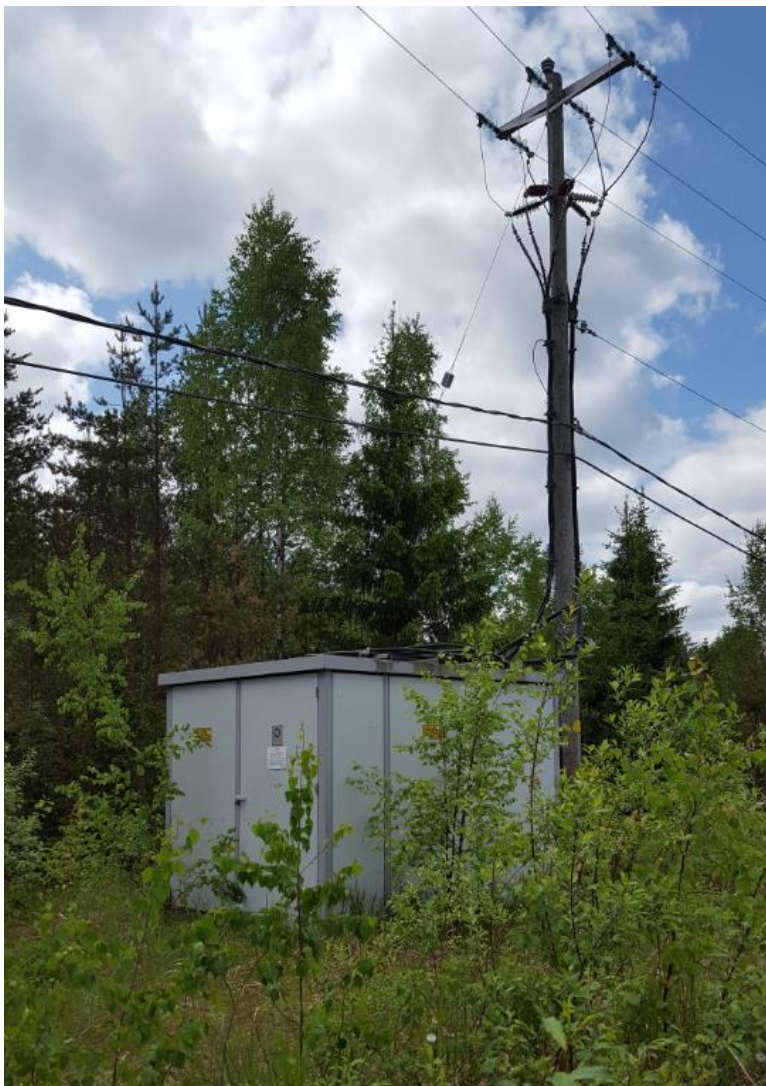
Kuva 2. Kaivoksen 20 kV:n energian mittauksella varustettu asiakasmuuntamo.
