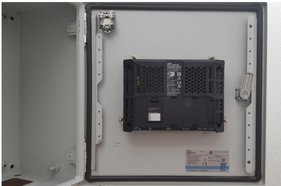
Kuva 20. HMI-paneeli sekä hätä seis painike asennettuna kotelon oveen.
