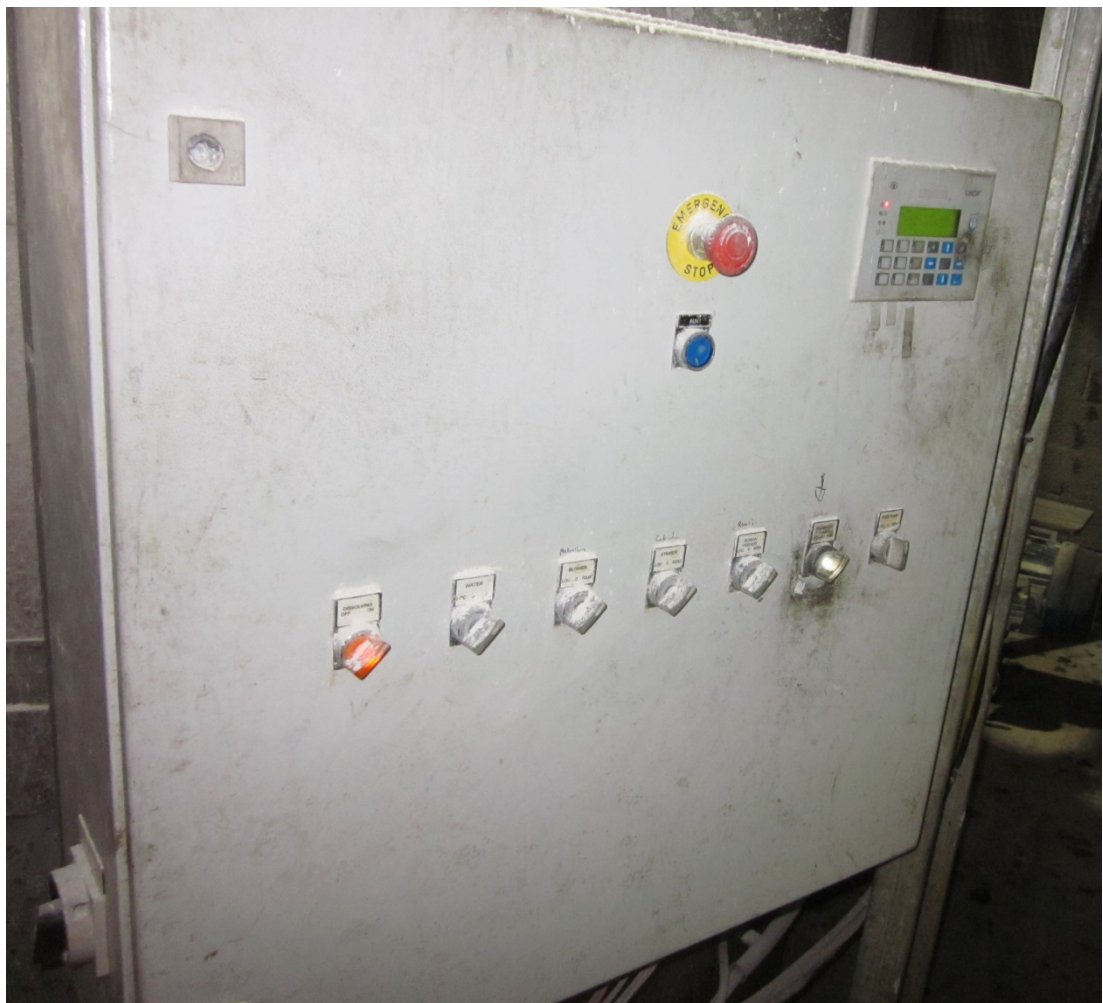
Kuva 4. Liutuslaitteiston sähkölaitetekotelo ja ohjauspaneeli
