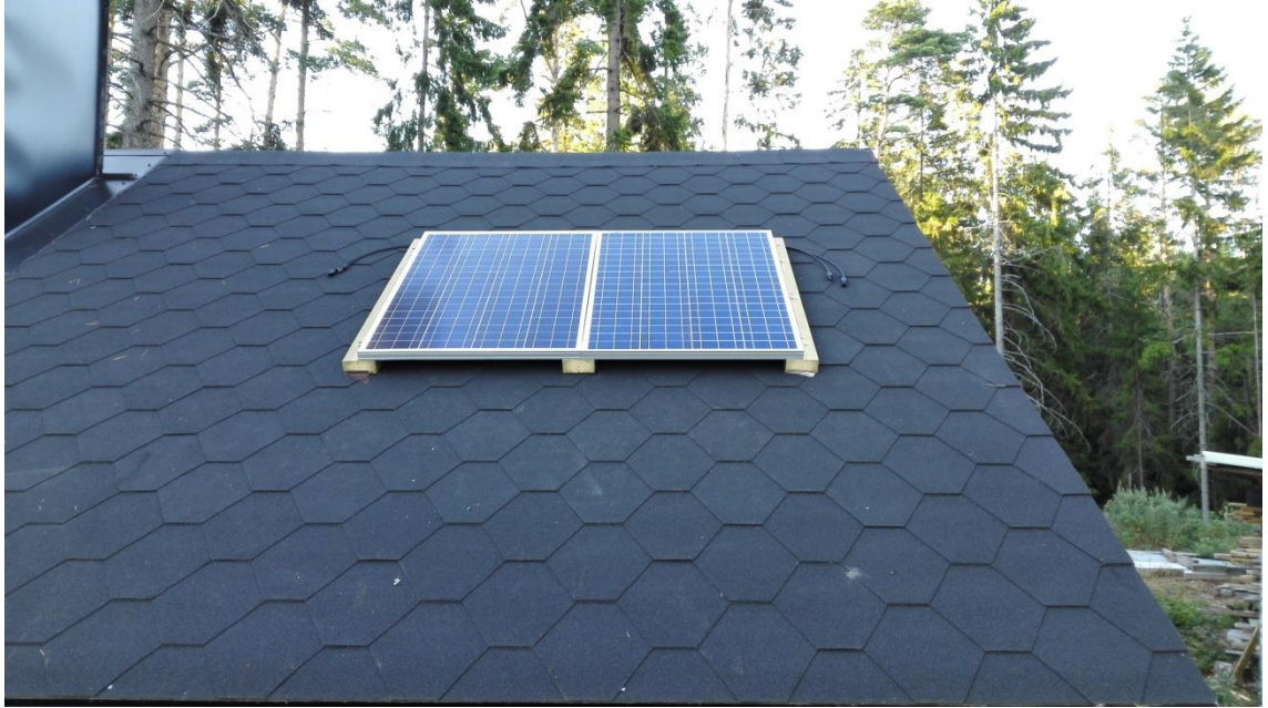
Kuva 6.1. Aurinkopaneelit asennettuna mökin katolle.
