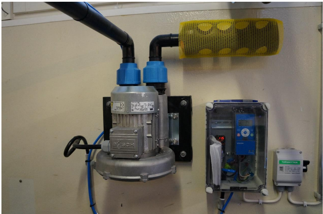
Kuva 17. Ilmapuhallin, paineanturi ja taajuusmuuttaja
