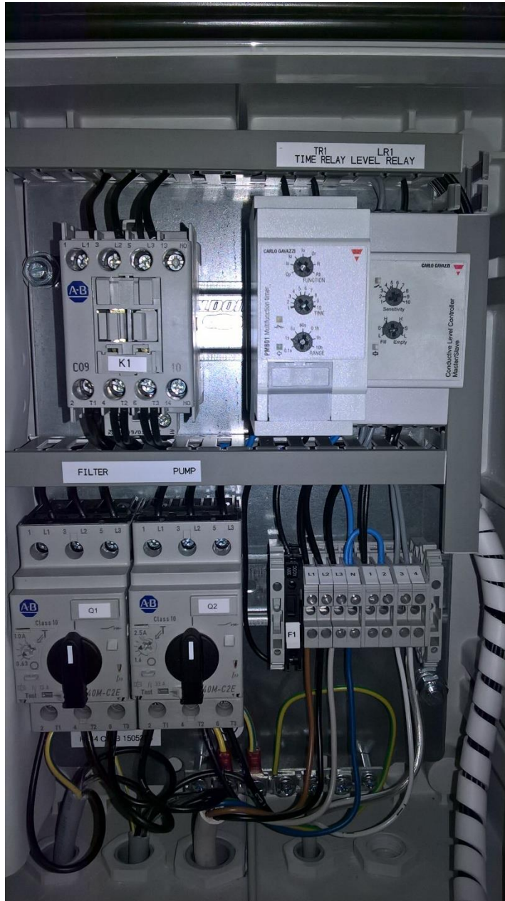
Kuva 19. Apukosketin vasemmalla ylhäällä kontaktorin oikeassa laidassa käyttämättömänä
