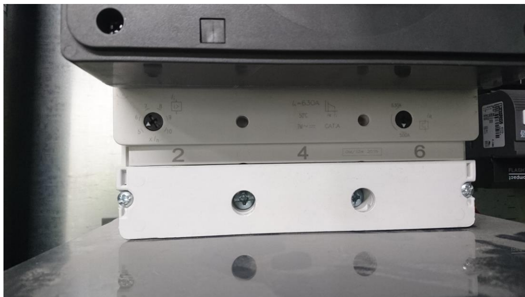
KUVA 17. 250 MCC, kompaktikatkaisija Siemens 3VL5763-2DC36-0AC1 (630A), laukaisuvirta 500A ja oikosulkuvirta 3150A.
