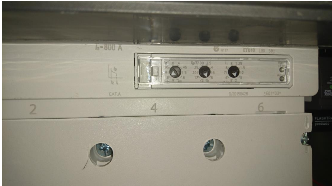
KUVA 16. 230 MCC, kompaktikatkaisija Siemens 3VL6780-2SB36-0AC1 (800A), laukaisuvirta 640A, laukaisuaika 10 s ja oikosulkuvirta 3200A.
