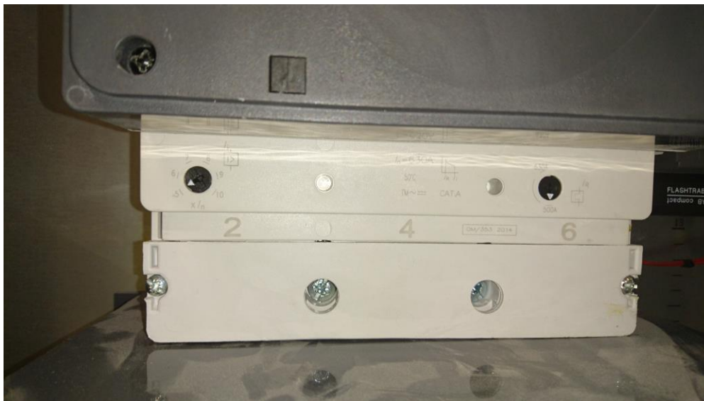
KUVA 15. 200 MCC, kompaktikatkaisija Siemens 3VL5763-2DC36-0AC1 (630A), laukaisuvirta 500A ja oikosulkuvirta 3150A.
