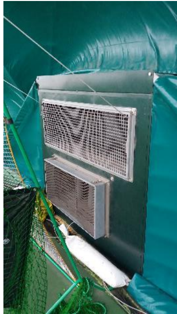
Kuva 8. Ylipainehallin tulo- ja paluuilmakehanavien suuaukot.
