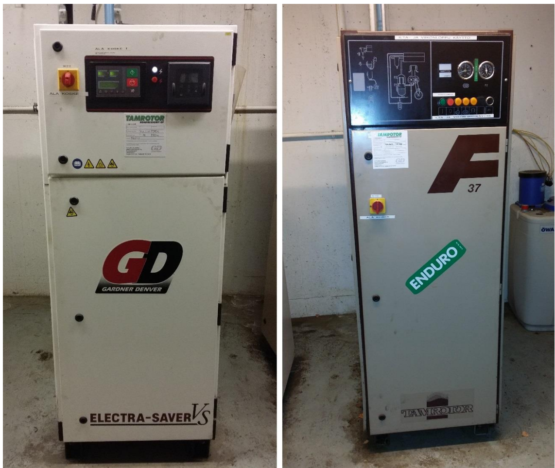
KUVA 7. Vasemmalla pääkompressori, oikealla varakompressori
