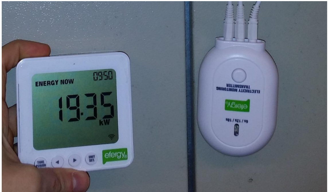
KUVA 10. Efergy e2 anturi/lähetin kiinnitettynä syöttökaapeleihin sekä vastaanottolaite
