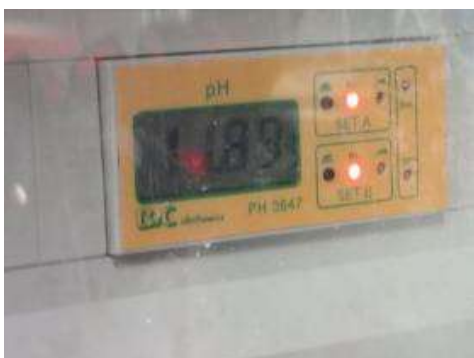
Kuva 12. 29.2.2016 mitattu prosessiveden korjaamaton pH-arvo.
