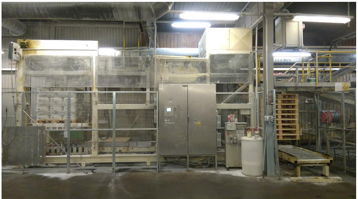
Kuva 17. Kuvassa ohjauspaneeli, jonka takana ylhäällä kuviohihna ja lavaaja
