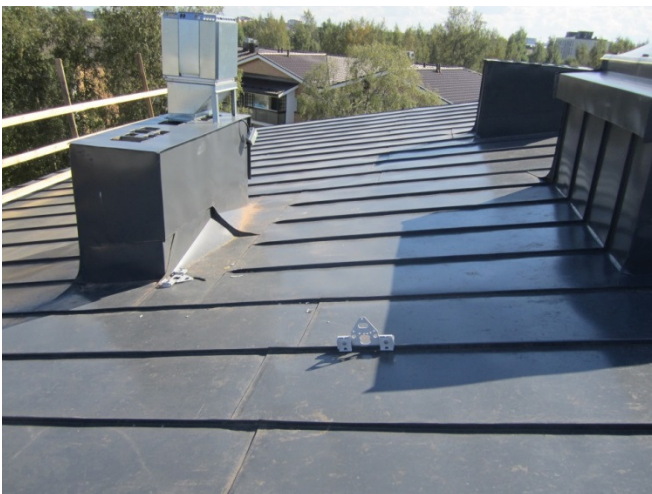
Kuva 3. Liian loiva konesaumakatto muutettiin kumibitumikermikatoksi vuoto-ongelmien vuoksi. (17.)
