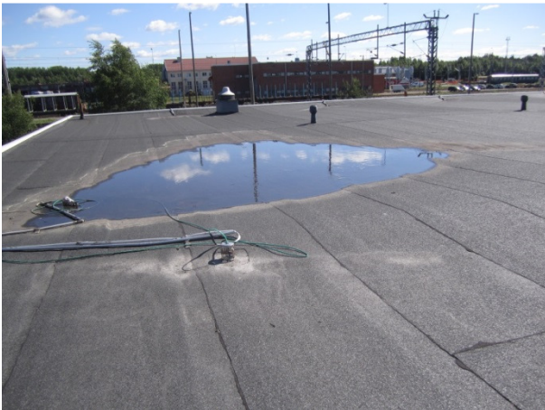
Kuva 19. Tukkeutunut kattokaivo voi aiheuttaa useita kymmeniä senttimetrejä syvän altaan katolle. (17.)
