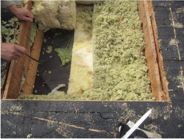
Kuva 31. Katon rakenteita on hyvä avata ja tutkia ennen korjausta tai korjauksen aikana. (17.)
