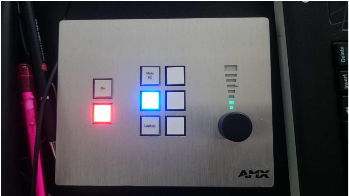
Kuva 13. AMX:n ohjauspaneeli projektoria ja äänijärjestelmää varten.
