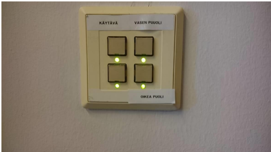
Kuva 12. Nykyisen valaistuksen ohjaukseen käytettävät painonapit.
