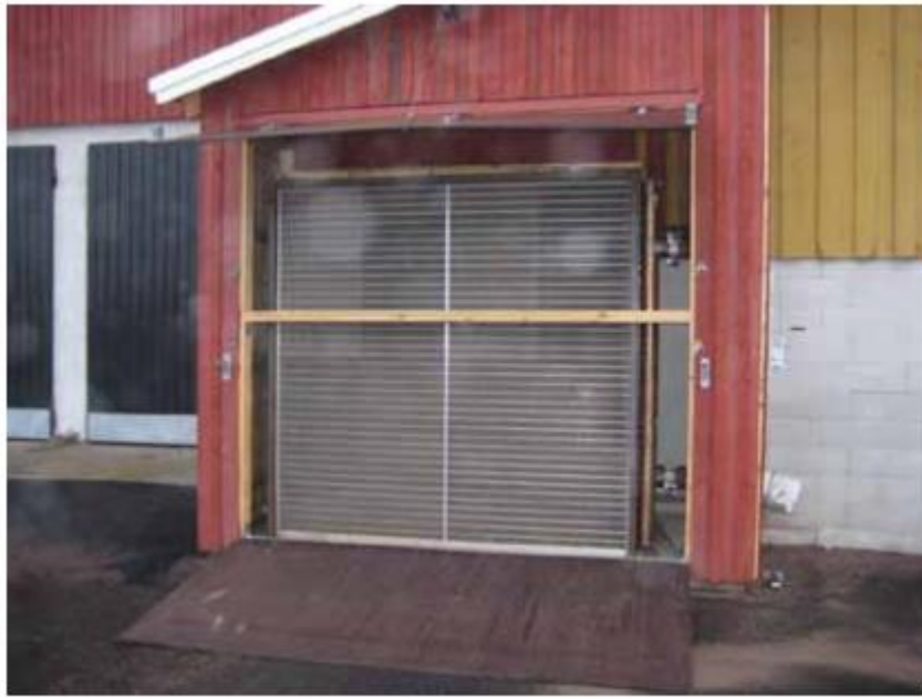
KUVA 10. Kuivuriuunin imuaukon eteen asennettu esilämmitin. (Karelia 2013, 18)
