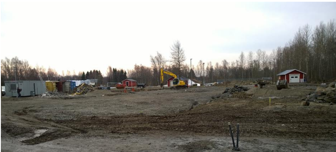
Figur 29. Bearbetade bergytan täcks med krossgrus #0–32 och #0–65. I detta skede kan krossgruset endast fyllas upp till höjden +5,99 angivet enligt höjdsystem N2000, eftersom 300 mm tjockt lager av dräneringsgrus (#8–16) skall rymma under grundsulan.
