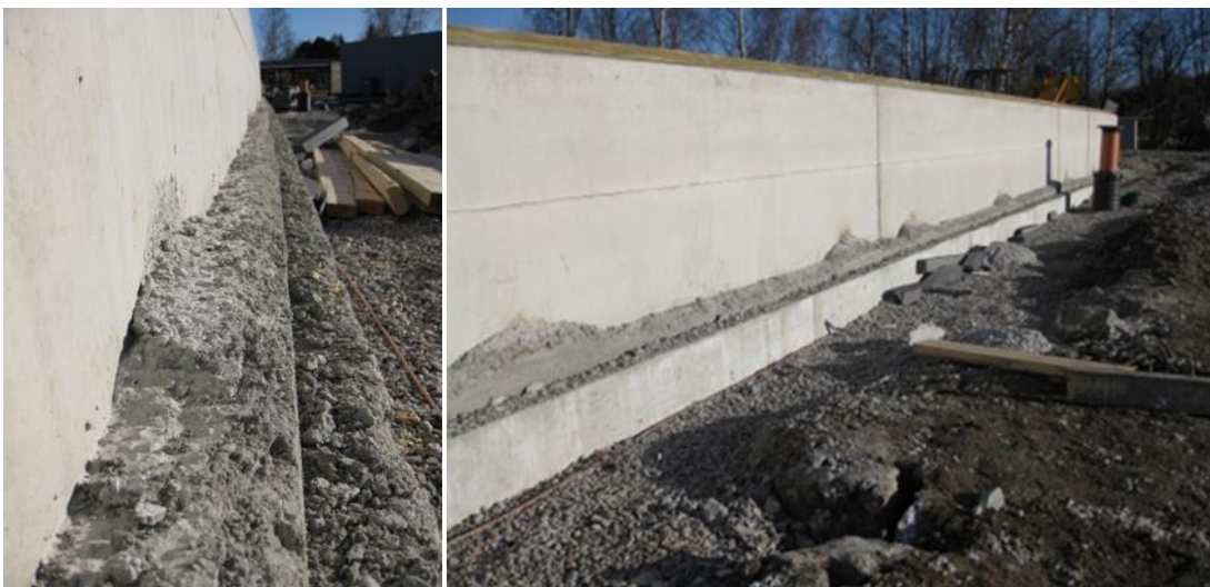
Figur 54. Enligt anvisningar bör ojämnheter och eventuella skador i grundmuren åtgärdas innan sockelskivan installeras. Eftergjutningen som observerades på byggarbetsplatsen var ojämn och arbetet var inte utfört enligt arbetsritningarna. På grund av detta gav byggherren huvudentreprenören åtgärdskrav.
