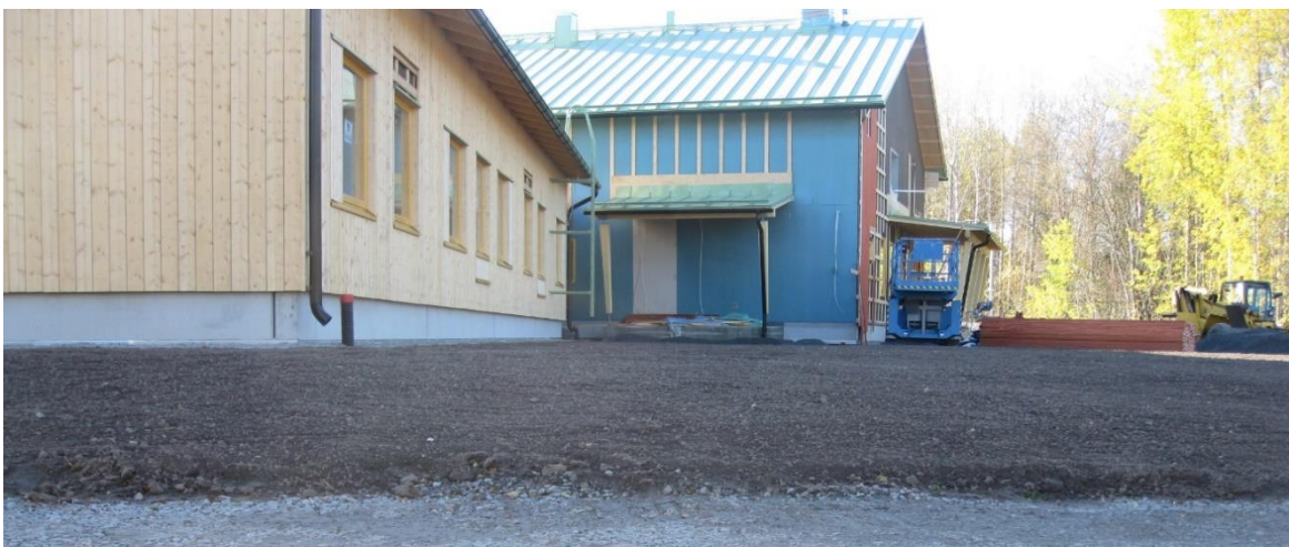
Figur 41. Markytan runt byggnaden sluttar från sockeln.
