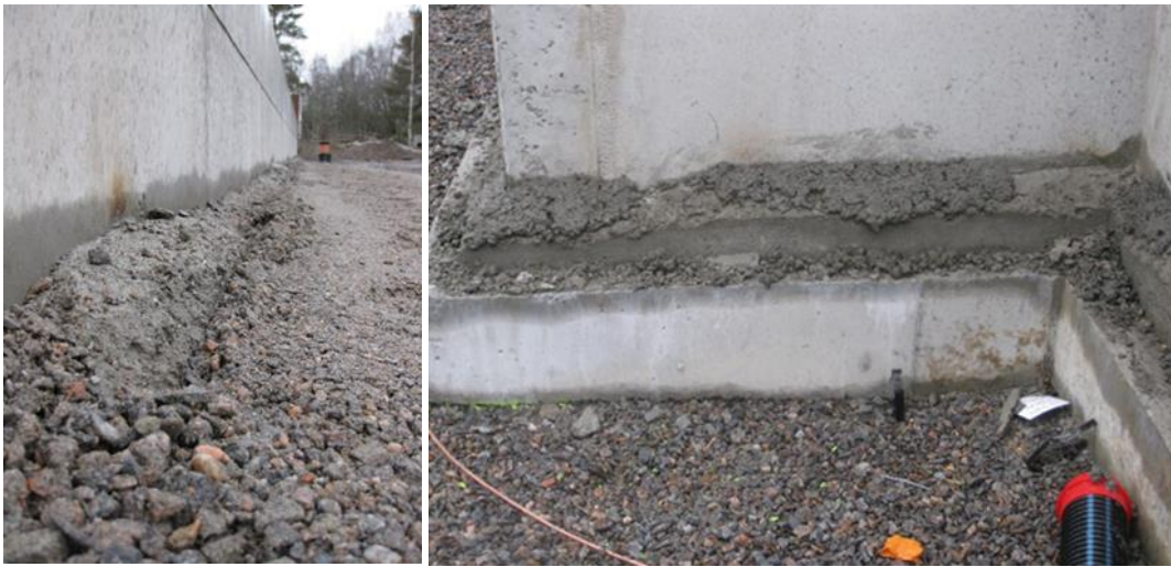
Figur 55. Den ojämna eftergjutningen åtgärdades med en ny gjutning ovanpå den gamla med lutningar bort från byggnaden. Arbetet som utfördes efter åtgärdskraven var inte mer än godtyckliga och därmed fanns fortfarande brister, men godkändes.
