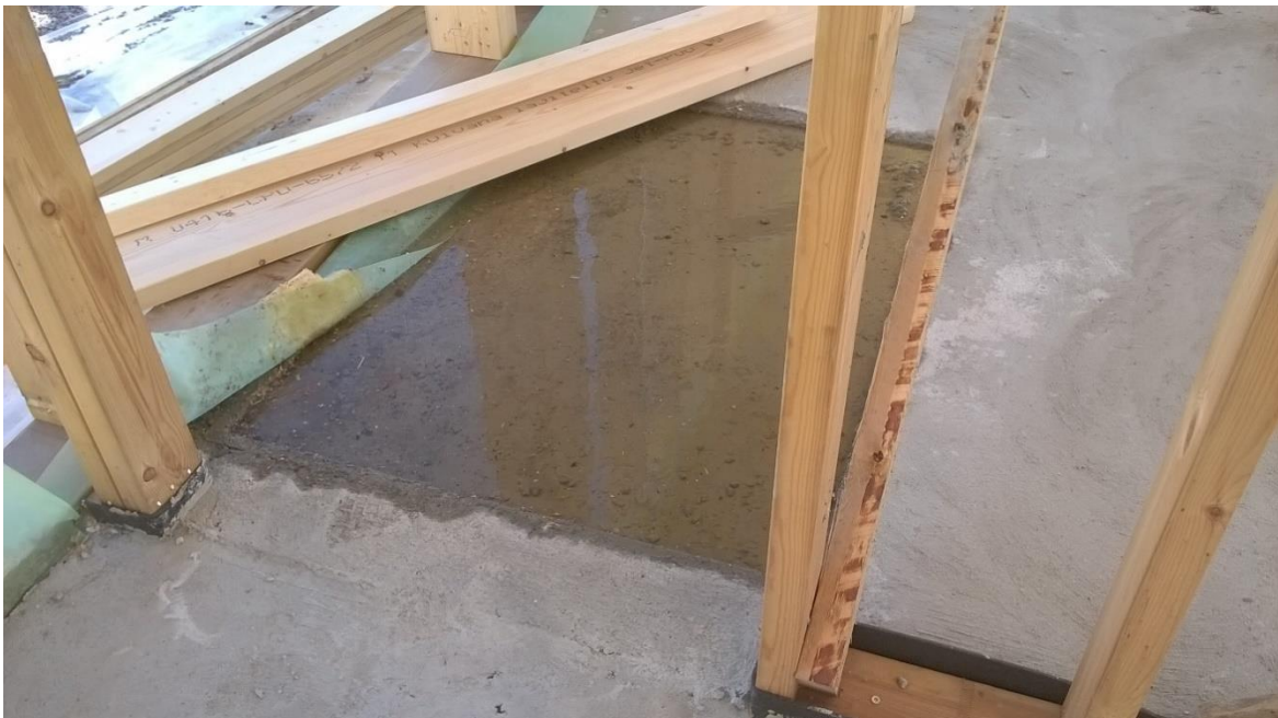
Figur 97. Nedsänkningen vid ingången samlade vatten vilket medförde en uppfuktning av betongplattan.
