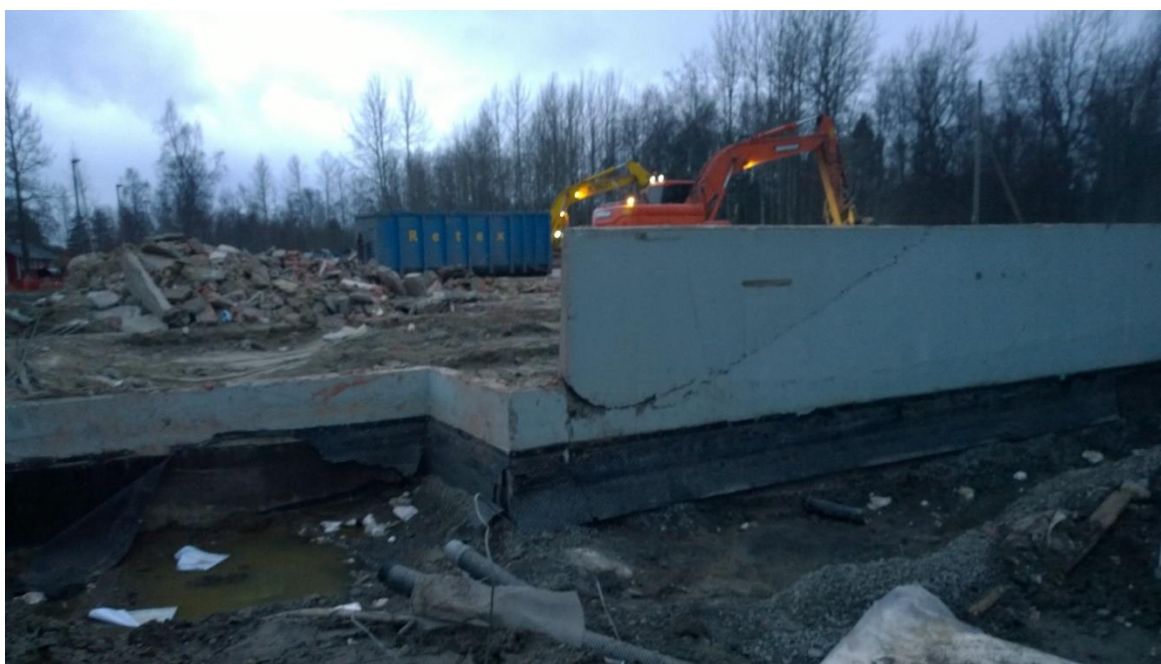
Figur 10. Fritt vatten ligger intill den idag rivna skolbyggnaden.
