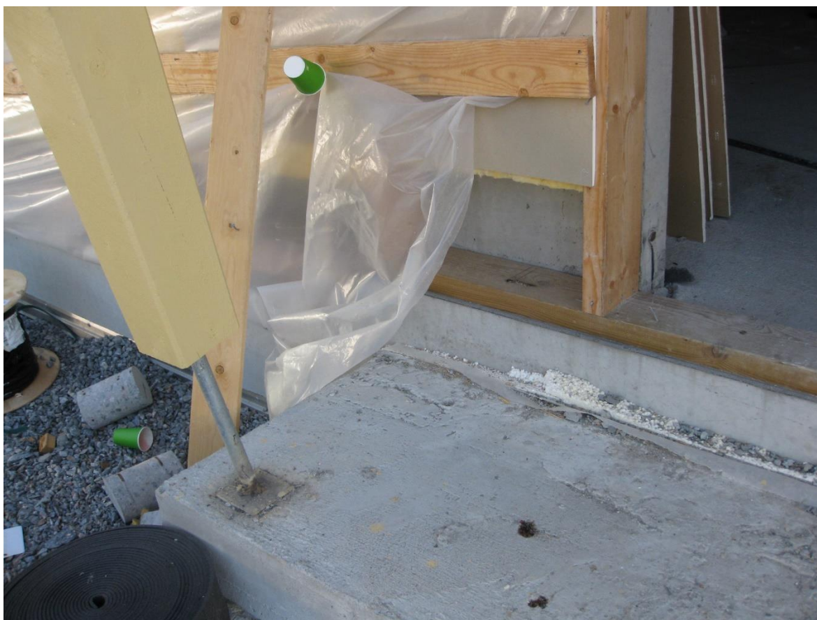
Figur 98. Syllens klimatskyddades och värmebläkt vid andra öppningen medförde ett klimat som främjade uttorkningen av byggfukt i syllarna.
