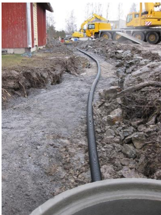
Figur 46. Vatten från dräneringsrören leds från byggnaden.
