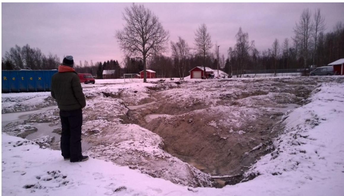
Figur 22. Bergytan ligger nära markytan och kan orsaka vattensamlingar under nya skolbyggnaden.
