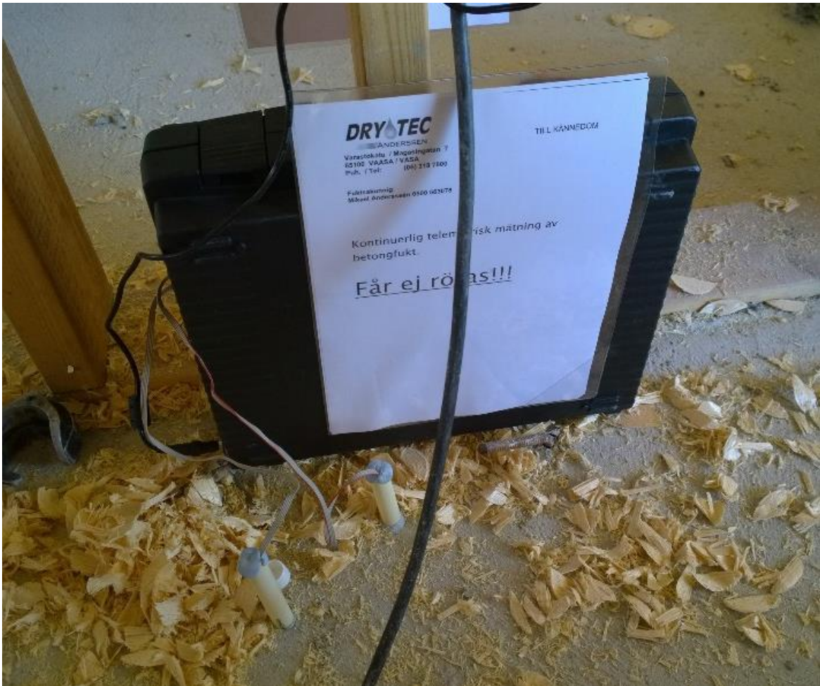
Figur 90. Termometrisk mätutrustning loggar betongplattans relativa fuktighet och temperatur.
