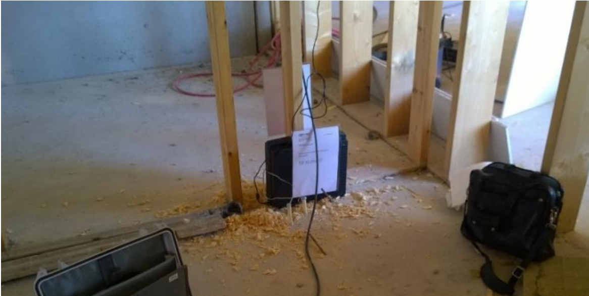
Figur 89. Termometrisk mätutrustning loggar betongplattans relativa fuktighet och temperatur.
