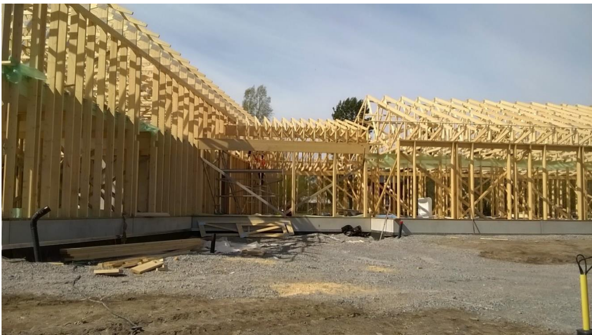
Figur 85. Takstolar monterade. Hunton undertaksskiva kunde därmed monteras ovanpå takstolarna för att snabbt få en klimatskyddad byggnad, vilket möjliggjorde en snabbare uttorkning av byggfukt i betongplattan
