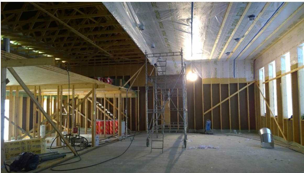
Figur 80. Värmeisolering placerades mellan väggreglerna. Intelligent ångspärren utfördes så att springor inte förekom.
