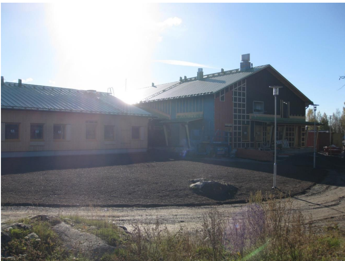
Figur 42. Marken runt byggnaden sluttar från sockeln.
