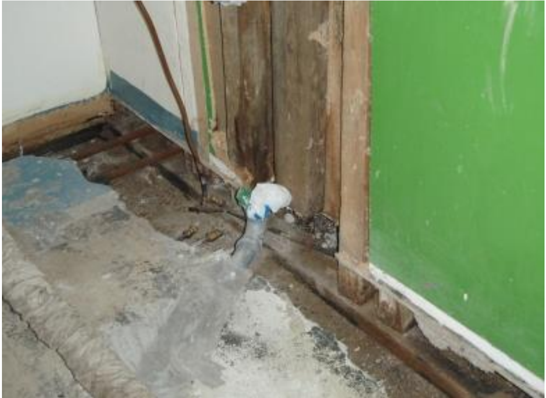
Kuva 2. Kaksoisbetonilaatan kosteusvaurio. (Ympäristöministeriö 2015)
