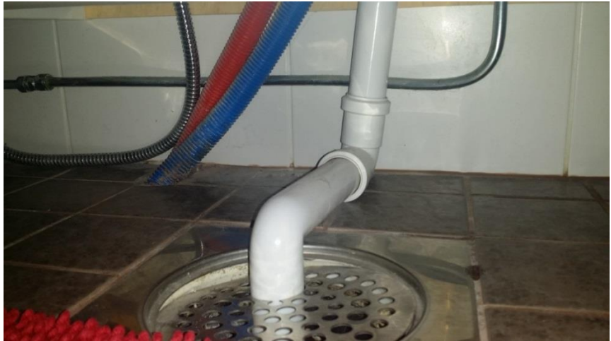
- Kuva 13. Pesuallas on viemäröity lattiakaivoon.
