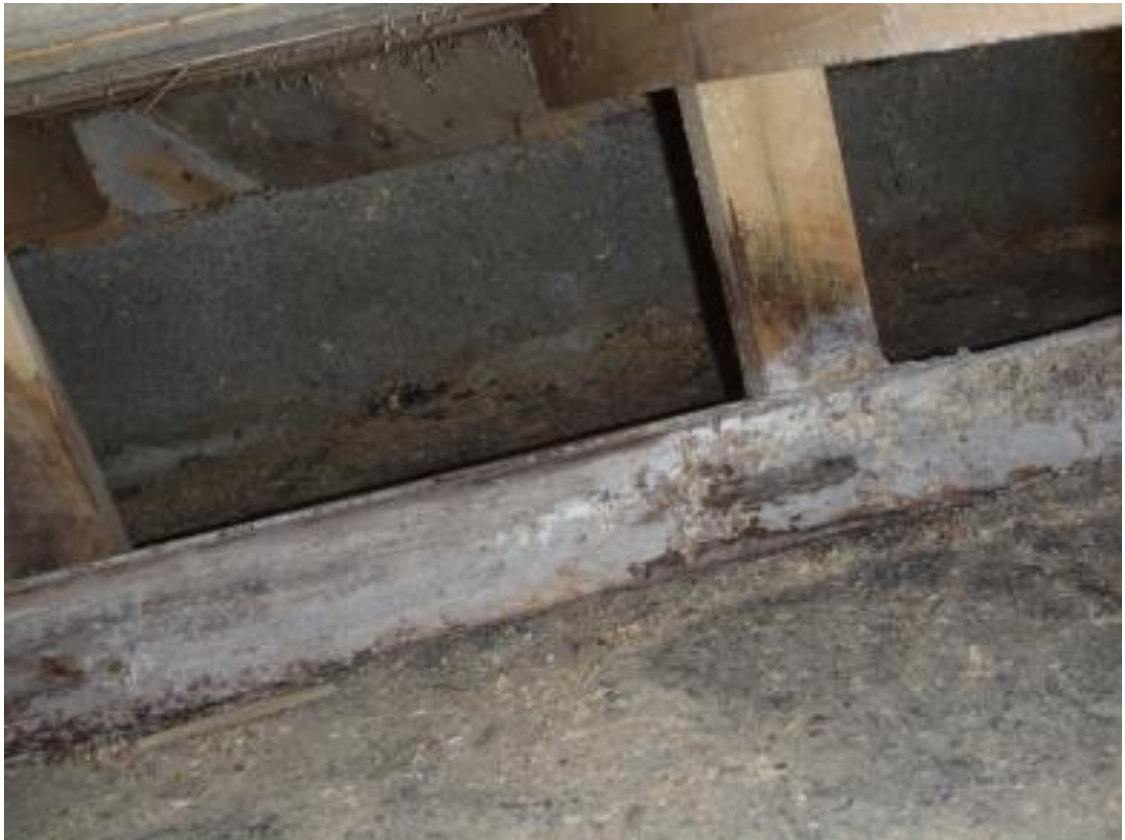
Kuva 3. Maanvaraisen laatan lattiakoolauksen kosteusvaurio.(Ympäristöministeriö 2015)
