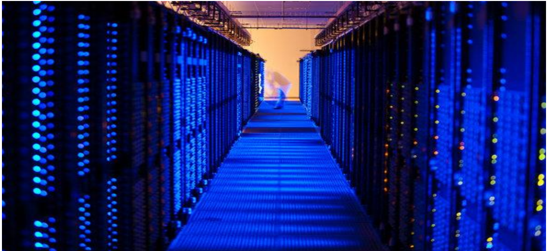
Kuva 6. Saksassa sijaitseva Amazon Web Servicesin datakeskus [16].
