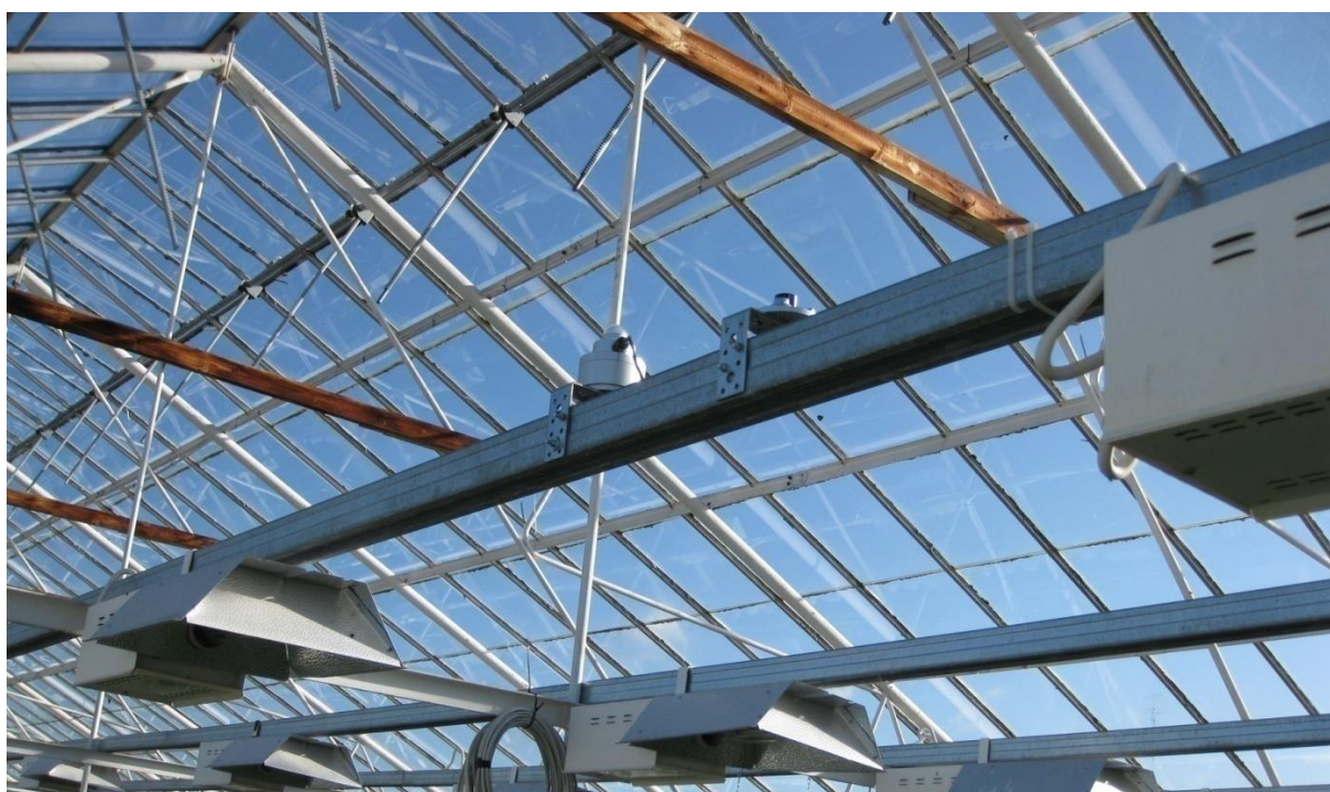
Figur 2 Innesensorernas placering i växthuset. Sensorerna är monterade ovanpå balken mitt i bild. Pyranometern ligger till vänster och PAR-sensorn till höger.
