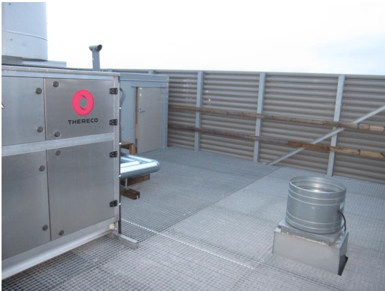
Kuva 61. Esimerkki Uima-altaan vanha poistopuhallin.
