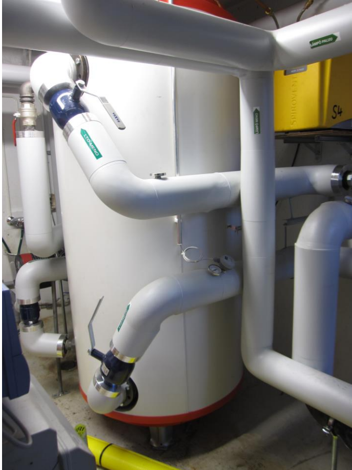
Kuva 37. 1 m 3 PILP-varaaja asuinkerrostalon lämmönjakohuoneessa.
