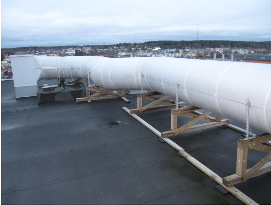
Kuva 39. Ilmanvaihtokanava vesikatolla. Kammion tilalla on ollut vanha huippumuri.
