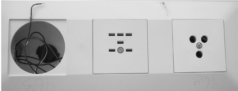
Johdot näkyvillä; 6 napainen heikkovirtapistorasia ja 3 napainen puhelin pistorasia
