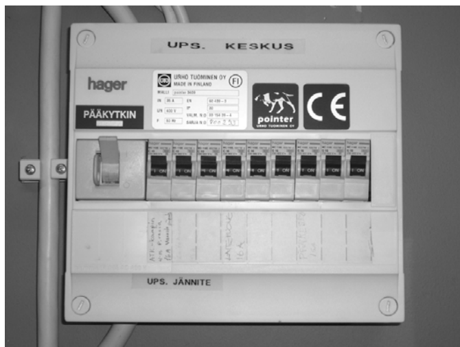
UPS-laitteisto ja keskus
