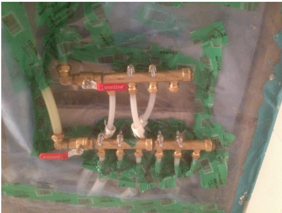
Kuva 41. Jakotukki pesuhuoneen katossa.
