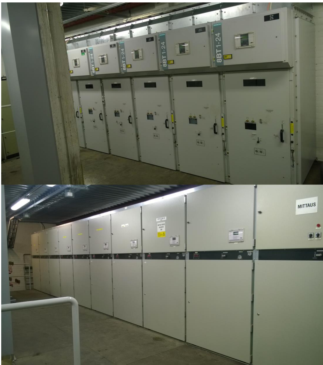
Kuva 3. Mäntänkosken kojeistot. 20A ylhäällä ja 20B alhaalla.
