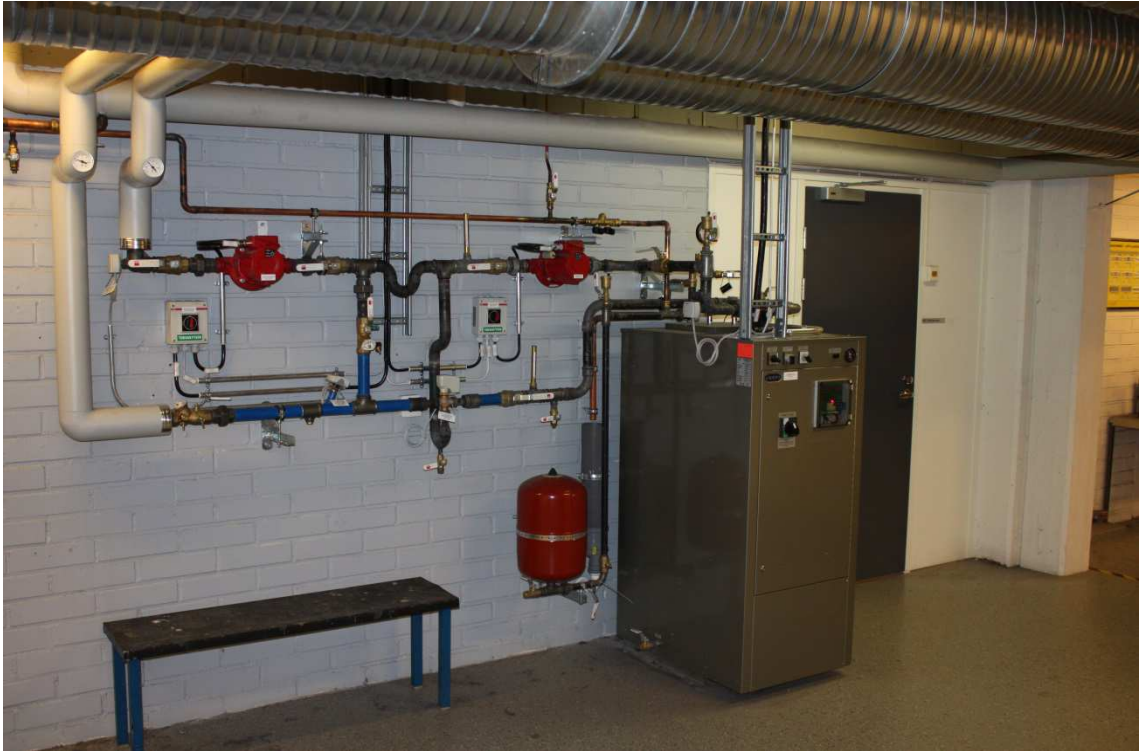
Kuva 4. Stingin ja HELI:n yhteinen lämmönjako
