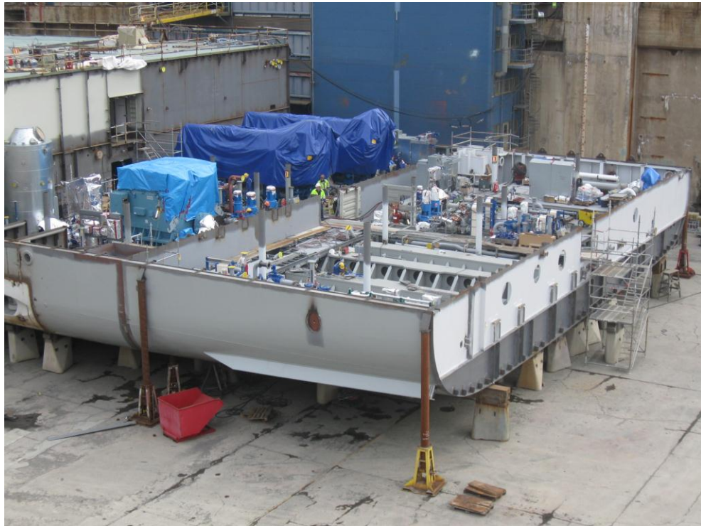
Kuva 20. Konehuonealueen lohko varusteltuna.
