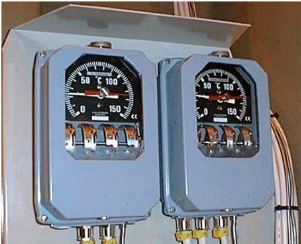
Kuvio 10 Muuntajan lämpömittarit (4-power-transformer-protection-devices-explained-in-details. 2015)
