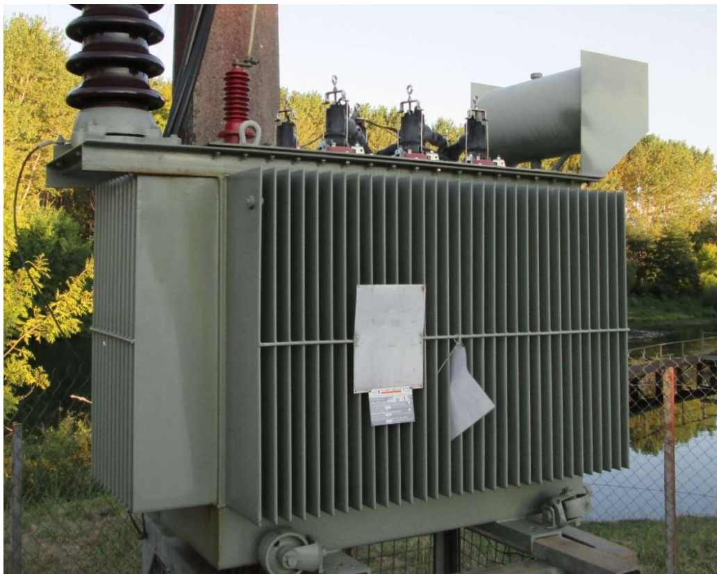
Kuvio 3 Paisuntasäiliöinen muuntaja (Power_transformer_decontaminated_in_France.jpg. 2014)
